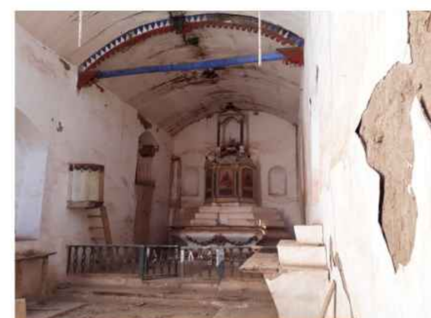
DESPRENDIMIENTO DEL REVOQUE INTERIOR
