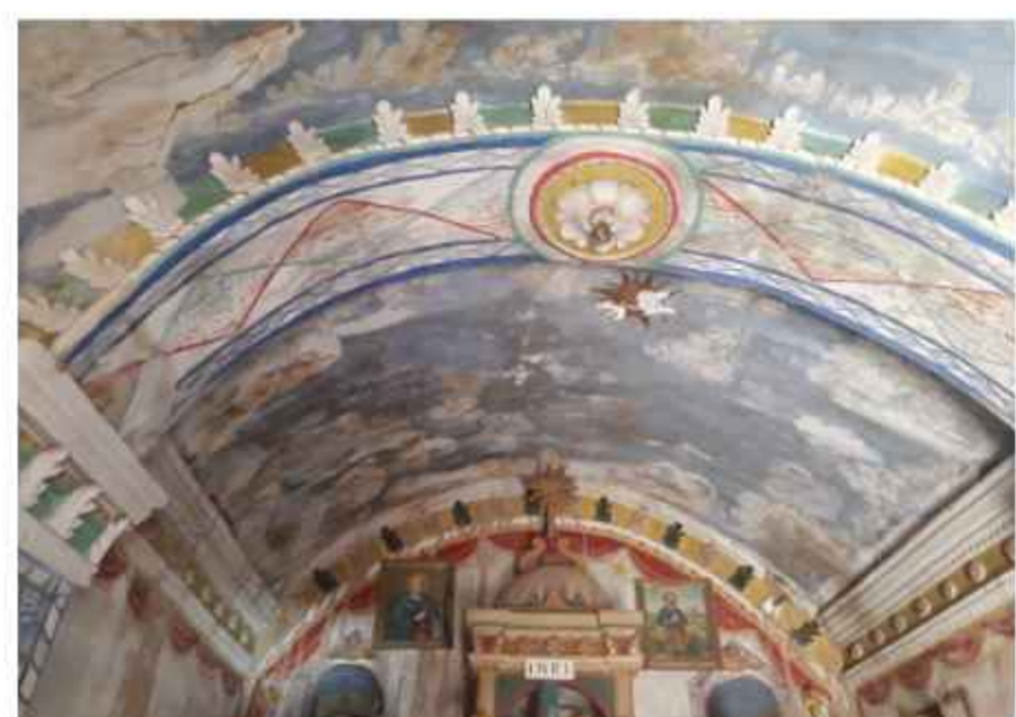
FILTRACIONES DE HUMEDAD EN EL CIELO FALSO
