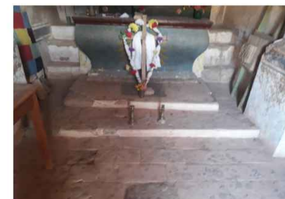
DETERIORO Y PIESAS ROTAS EN EL PISO DE LADRILLO
