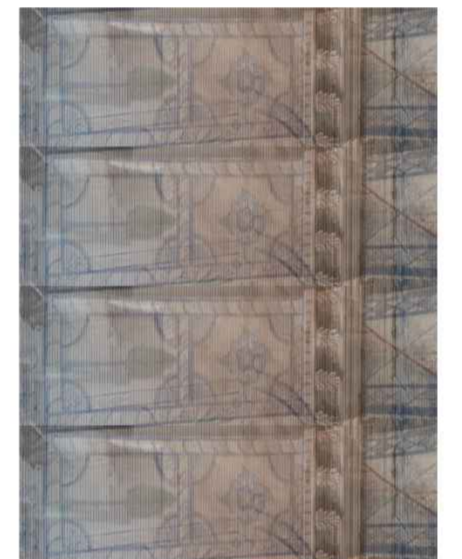
DESPRENDIMIENTO DE REVOQUE EN LA COLUMNA
