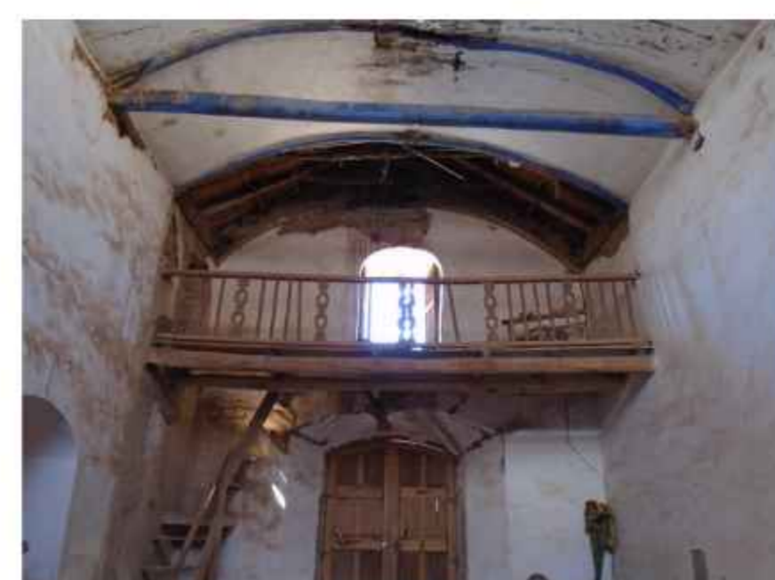
DETERIORO DEL BALCON
