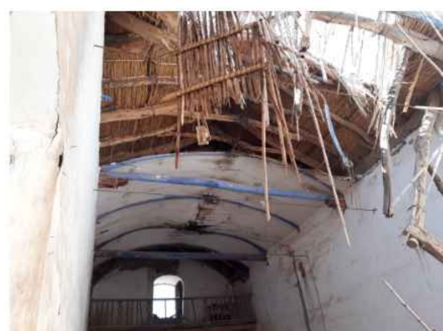
DERRUMBE DEL CIELO FALSO
