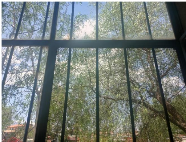
Ilustración 3-3 Ventanas con mallas de la empresa
