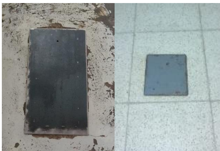
Ilustración 3-1 Desagües con tapa de la empresa
