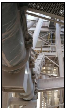
Filtro y chute de purga
