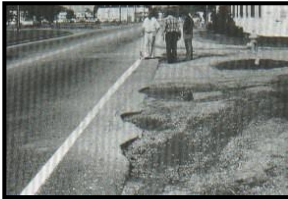
Figura 31 Grieta de borde de alta severidad
