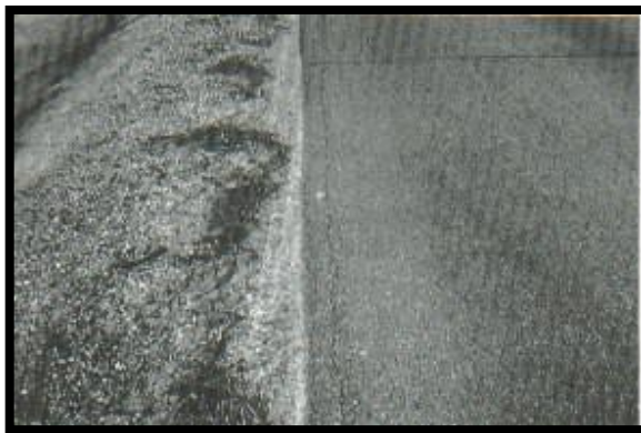
Figura 29 Grieta de borde de baja severidad
