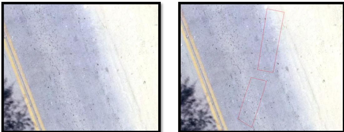
Figura 146 Identificación de fallas. Tramo 12 (prog. 6+074 - prog. 6+105)
