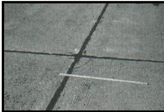
Figura 108 Descascaramiento de esquina de baja severidad.
