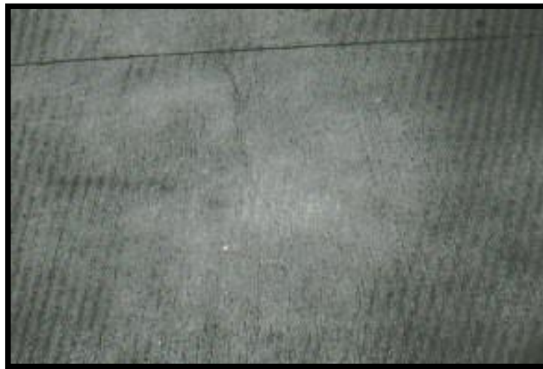
Figura 107 Grietas de contracción.
