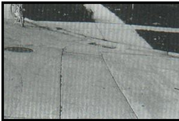
Figura 88 Parche grande y acometidas de servicios públicos de baja severidad
