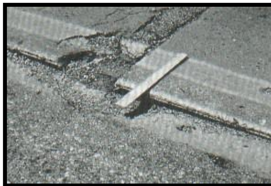
Figura 82 Desnivel carril / berma de baja severidad
