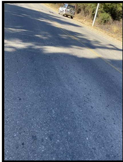
Figura 158 Fotografía de campo correspondiente al ahuellamiento
