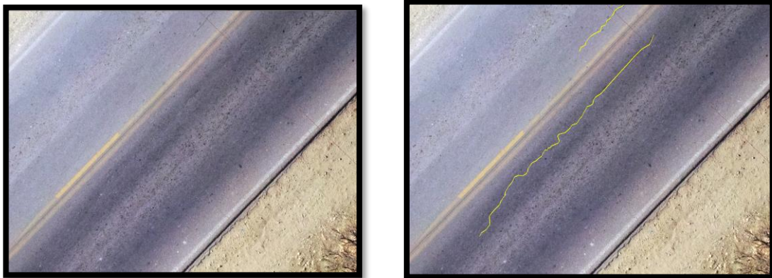
Figura 144 Identificación de fallas. Tramo 1 (prog. 0+188 – prog. 0+220)
