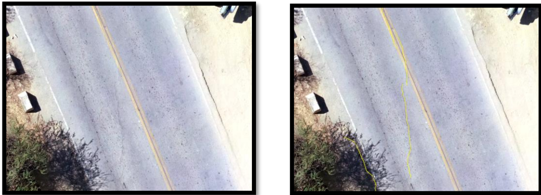
Figura 145 Identificación de fallas. Tramo 12 (prog. 6+074 - prog. 6+105)
