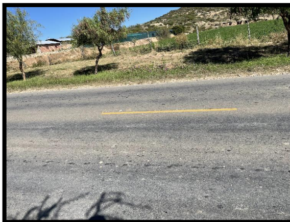
Figura 153 Fotografía de campo correspondiente al ahuellamiento
