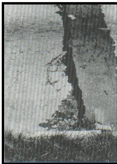
Figura 64 Blowup / Buckling de baja severidad
