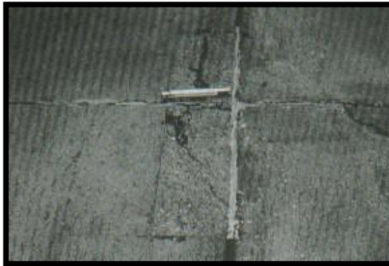
Figura 93 Parche pequeño de alta severidad
