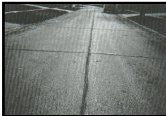
Figura 32 Grieta de reflexión de junta de baja severidad
