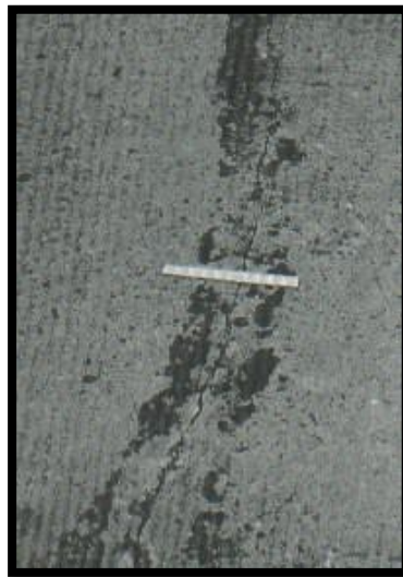
Figura 85 Grietas lineales de baja severidad en losa de concreto simple
