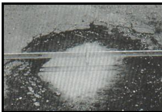
Figura 47 Hueco de severidad alta
