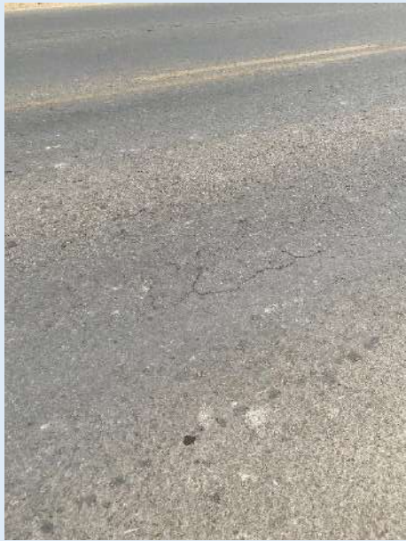
Punto de medición de falla
