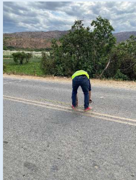
Punto de medición de la falla
