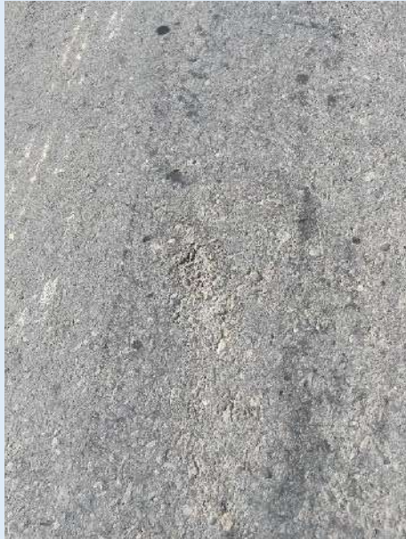
Desprendimiento de agregados
