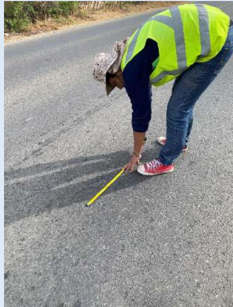
Punto de medición de falla
