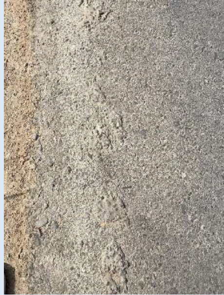
Desprendimiento de agregados
