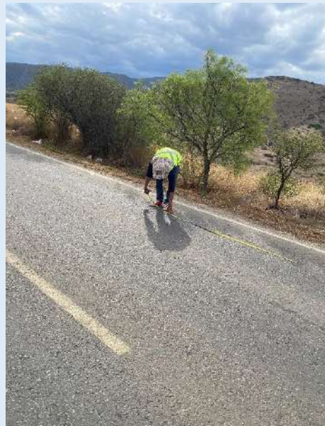
Punto de medición de falla
