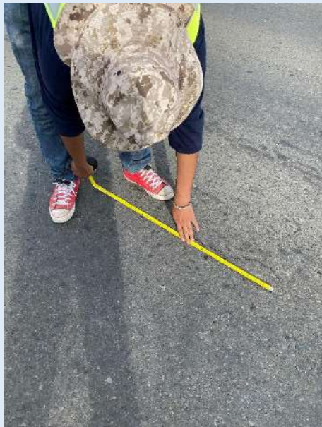
Punto de medición de falla
