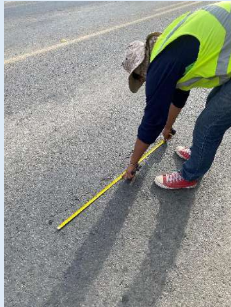
Punto de medición de falla
