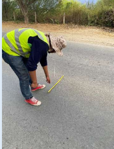
Punto de medición de falla
