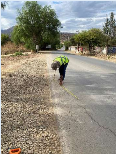
Punto de medición de la falla
