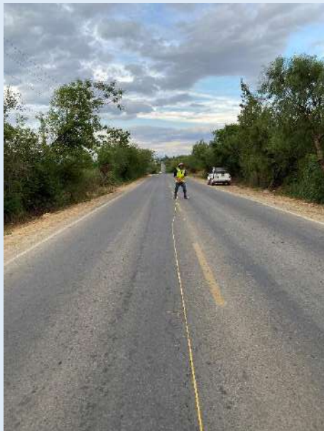
Punto de medición de falla
