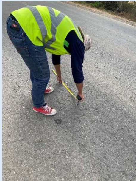
Punto de medición de falla
