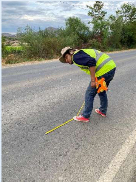
Punto de medición de falla
