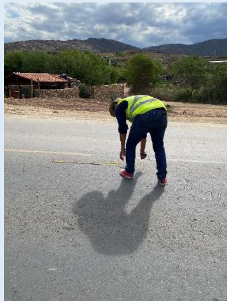
Punto de medición de la falla
