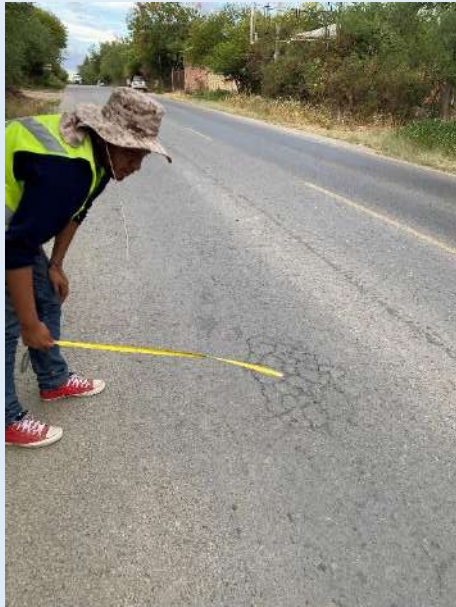
Punto de medición de falla
