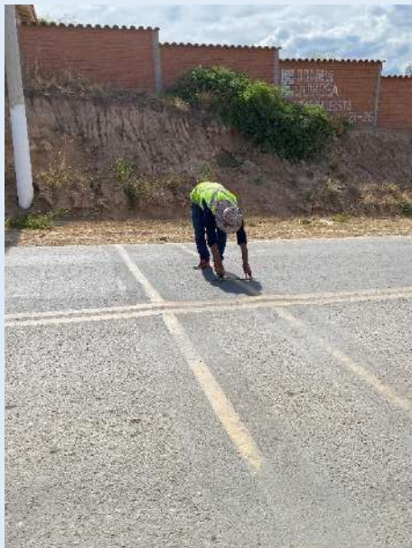
Punto de medición de la falla
