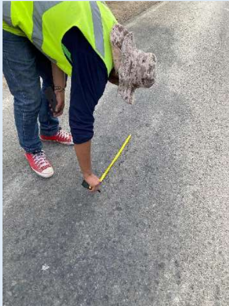
Punto de medición de falla
