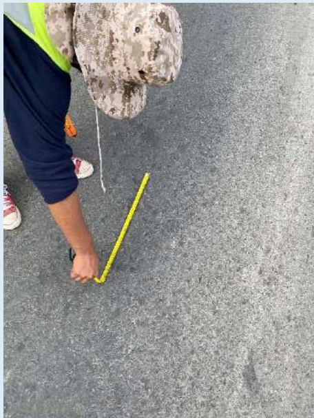
Punto de medición de falla
