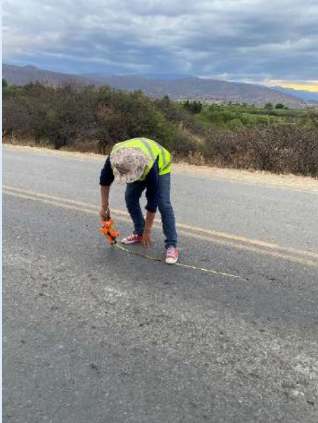
Punto de medición de falla
