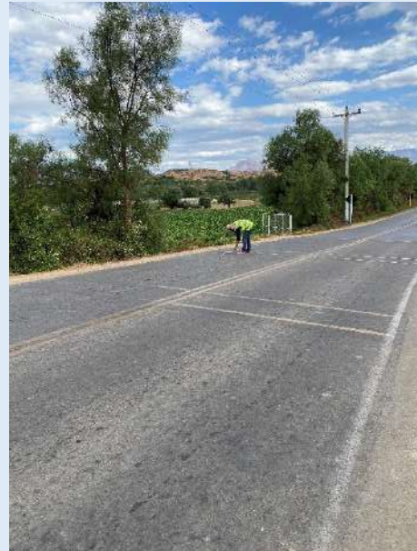
Punto de medición de la falla
