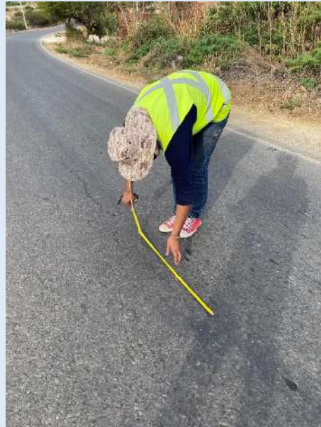
Punto de medición de falla
