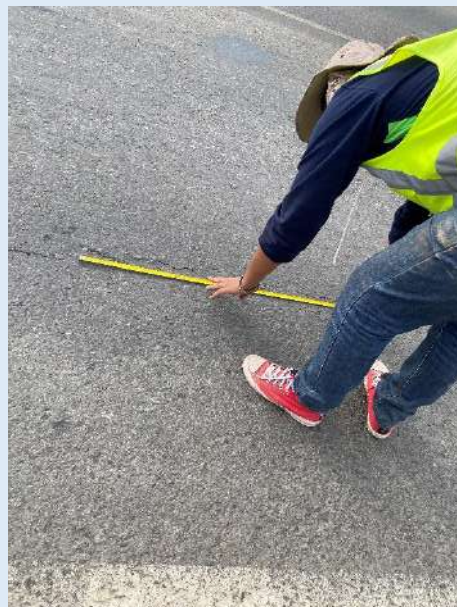
Punto de medición de falla
