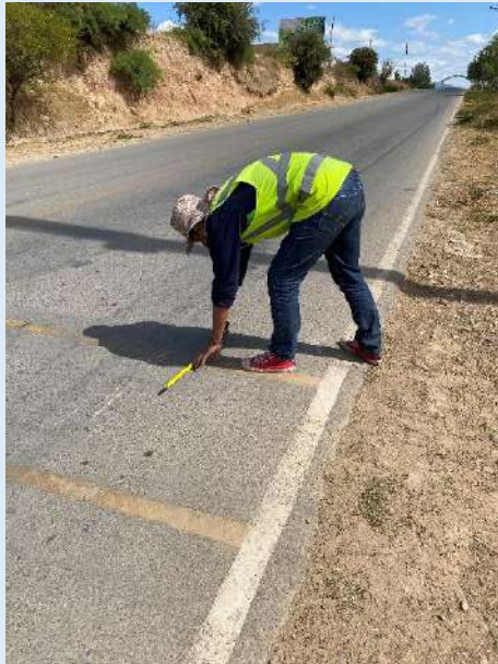
Punto de medición de la falla
