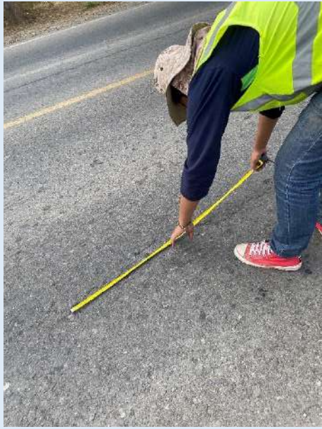
Punto de medición de falla
