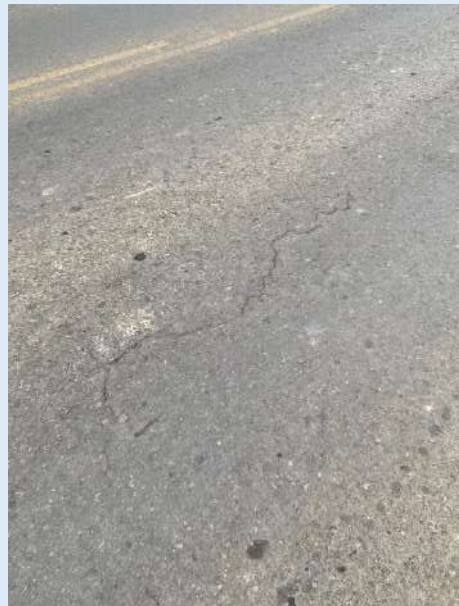
Punto de medición de falla
