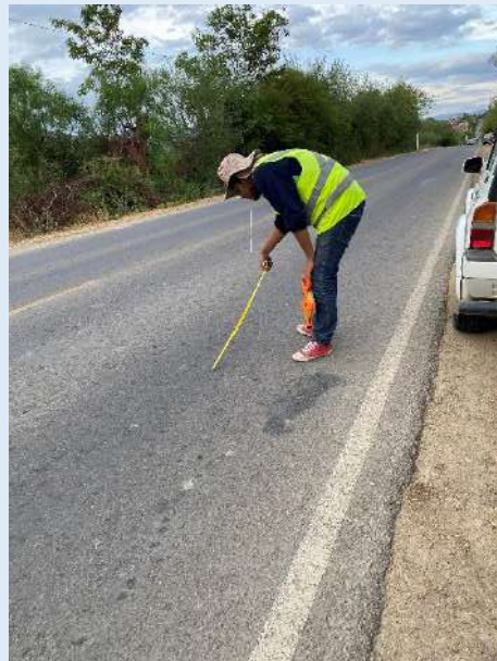
Punto de medición de falla
