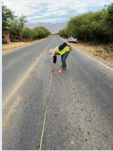
Punto de medición de falla
