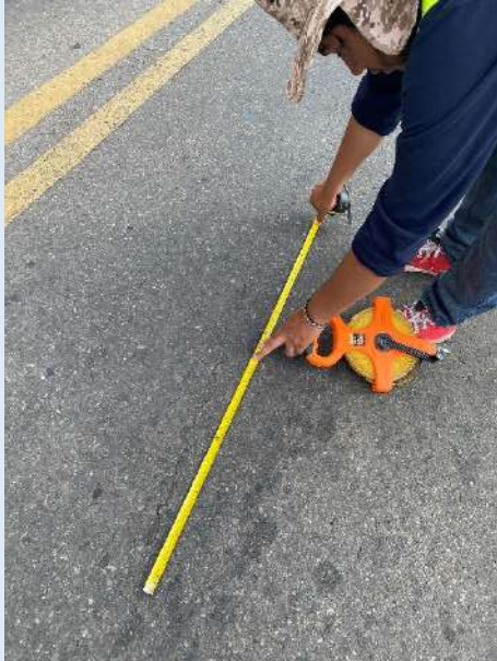
Punto de medición de falla
