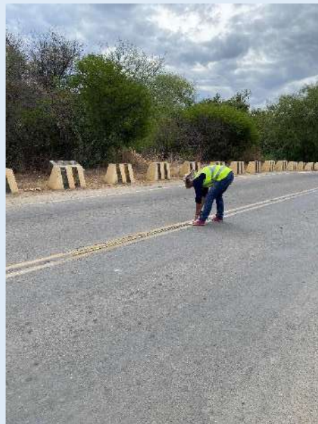
Punto de medición de falla
