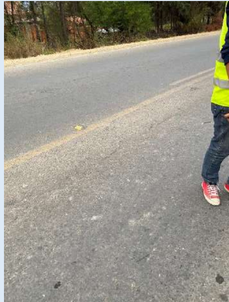
Punto de medición de falla
