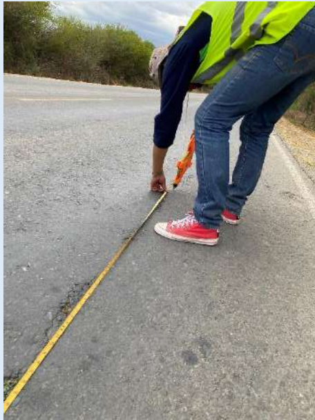
Punto de medición de falla
