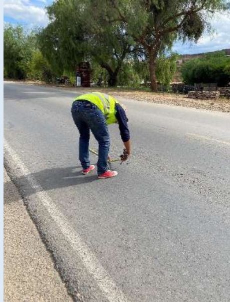
Punto de medición de falla
