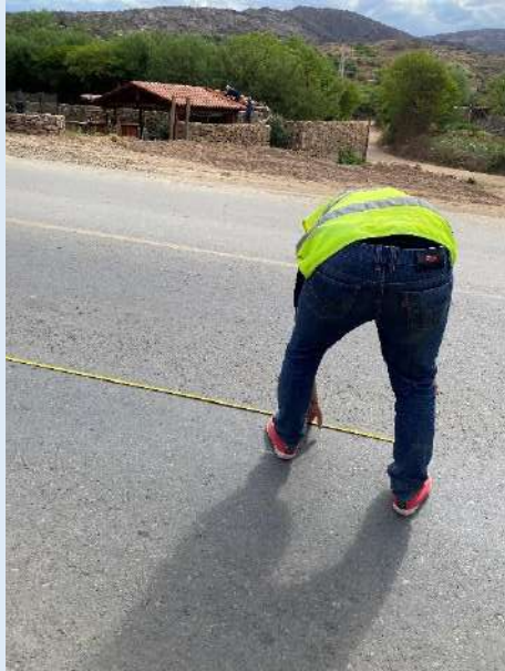
Punto de medición de falla
