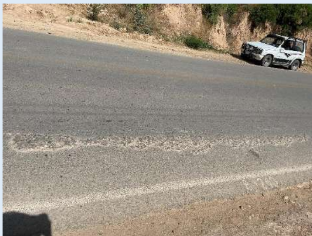
Bacheo mal realizado
