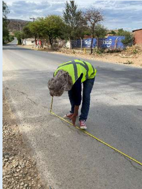
Punto de medición de la falla
