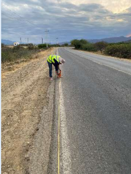
Punto de medición de falla
