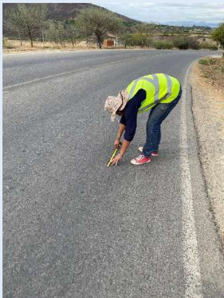
Punto de medición de falla
