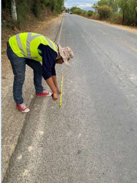
Punto de medición de falla
