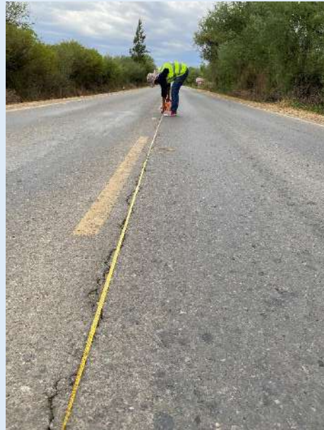
Punto de medición de falla
