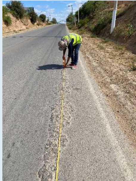
Punto de medición de la falla
