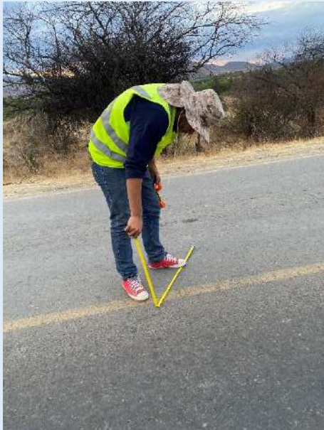
Punto de medición de falla
