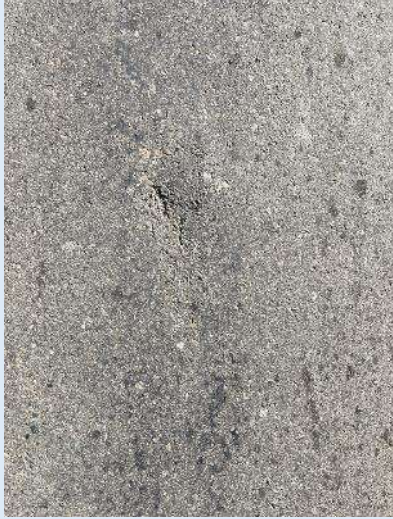
Falla: 19 H ,Cantidad: 0.21
