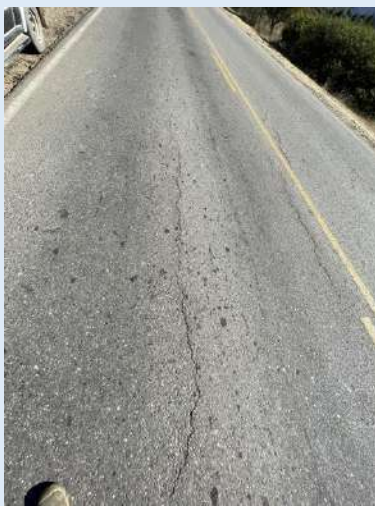
Falla: 10 M ,Cantidad: 2.76
