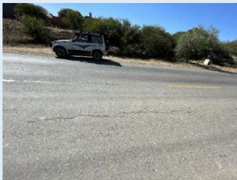
Falla: 10 M ,Cantidad: 4.28
