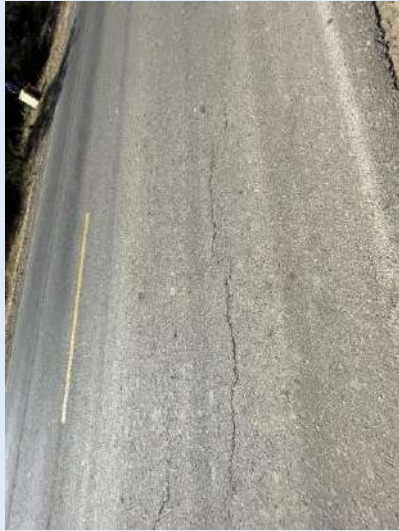
Falla: 10 M ,Cantidad: 3.1
