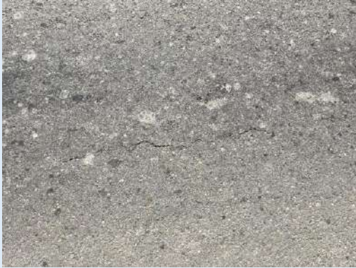
Falla: 10 M ,Cantidad: 1
