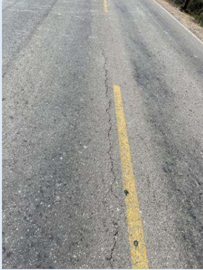
Falla: 10 M ,Cantidad: 8.43
