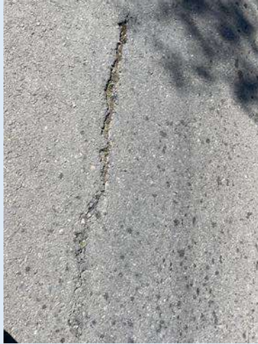
Falla: 10 H, Cantidad: 1.6
