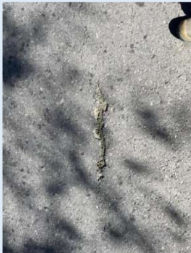
Falla: 10 H ,Cantidad: 0.5
