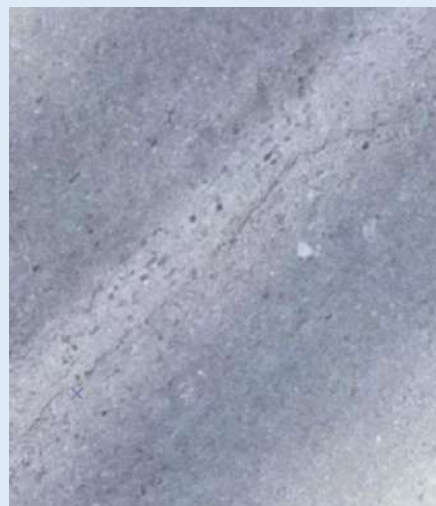
Falla: 10 M ,Cantidad: 2.87
