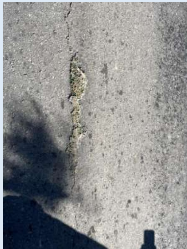
Falla: 10 H ,Cantidad: 7
