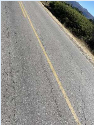
Falla: 10 M, Cantidad: 5.6
