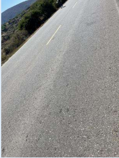
Falla: 15 H ,Cantidad: 3.54
