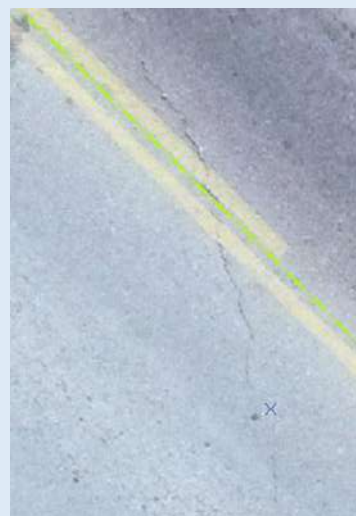
Falla: 10 M ,Cantidad: 5.78
