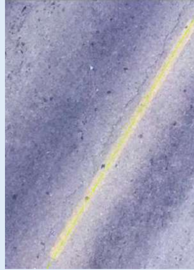
Falla: 10 M ,Cantidad: 7.455
