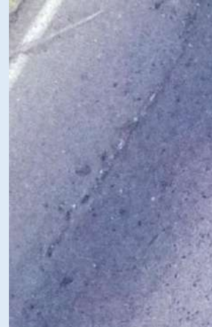
Falla: 10 H, Cantidad: 1.85
