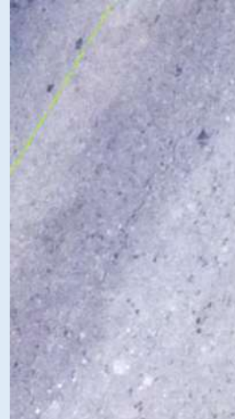
Falla: 10 H ,Cantidad: 9.04
