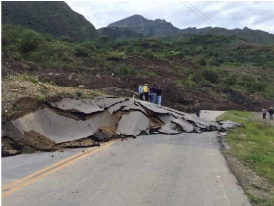
Figura 1.1. Deslizamiento de talud en la localidad de Guayabillas
