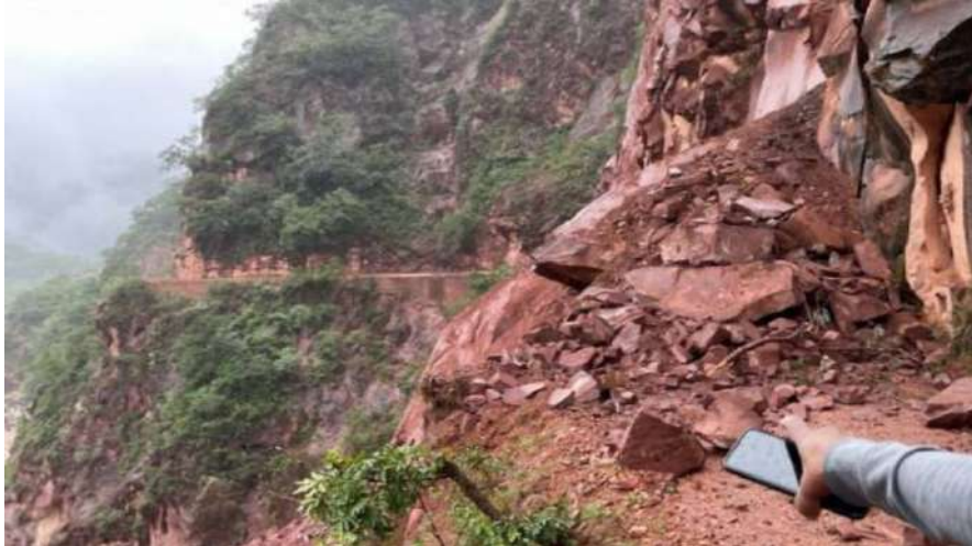
Figura 1.3. Deslizamiento sector Angosto ruta Tarija-Villa Montes
