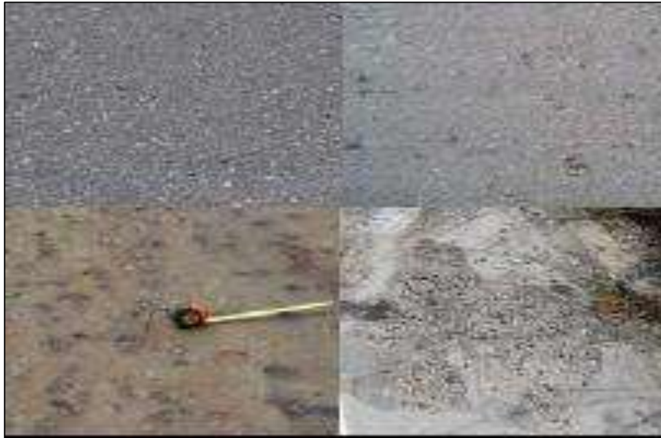
Figura 22 Pérdida de áridos
