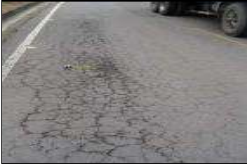
Figura 11 Fisuras y grietas por fatiga
