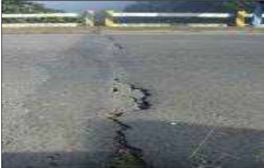
Figura 15 Fisuras y grietas reflejadas
