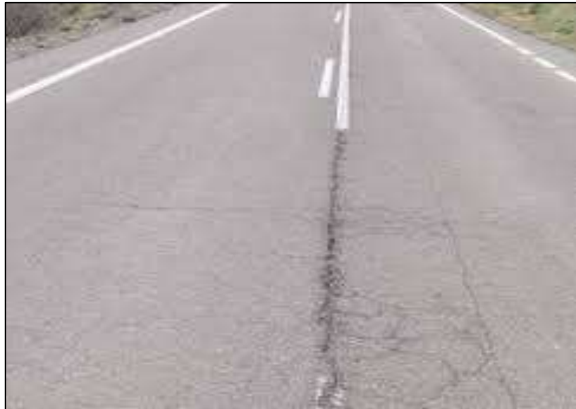
Figura 14 Fisuras y grietas longitudinales y transversales
