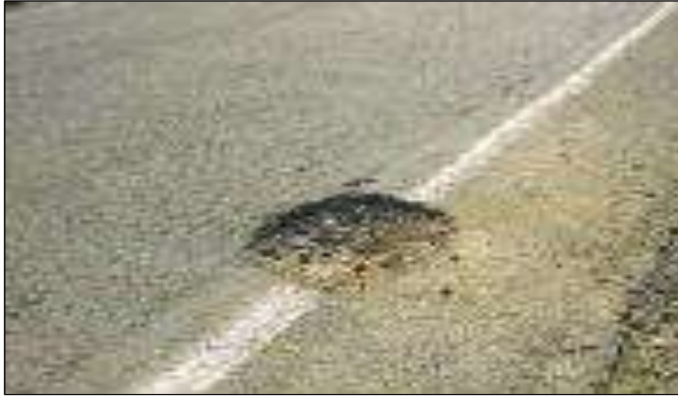
Figura 17 Baches en carpetas asfálticas
