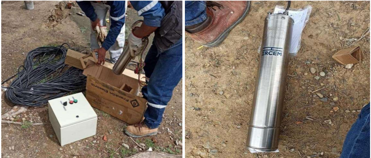
Ilustración 5. Electrobomba y tablero de control. Fuente: Elaboración propia.
