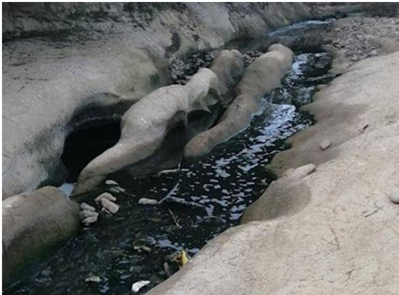
Figura 26 Escurrimiento de aguas de alcantarillado provenientes de la ciudad.
