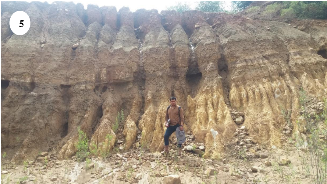
Fig. 5 Erosión en surcos con una gran pérdida de suelo por el desprendimiento y transporte a lo largo de canales intermitentes con avance hacia arriba por las lluvias
