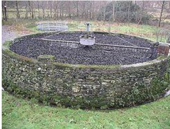
Figura 1 - 7 Filtro oxidante en una planta rural.
