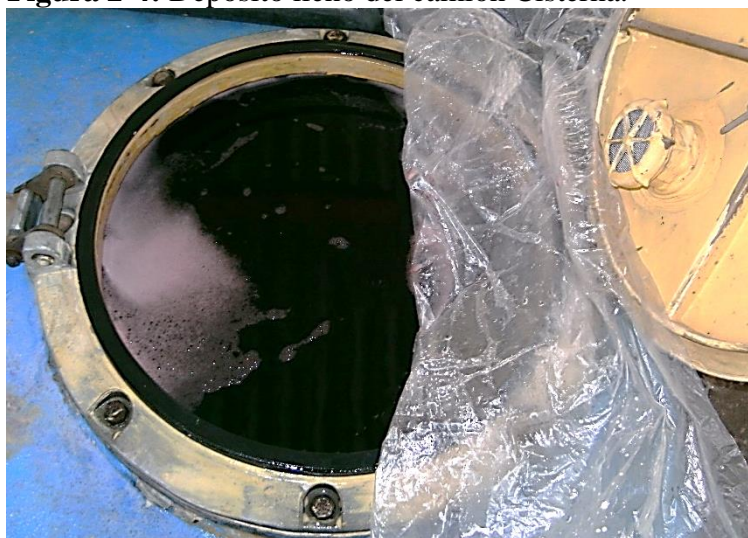
Figura 2-4: Depósito lleno del camión Cisterna.
