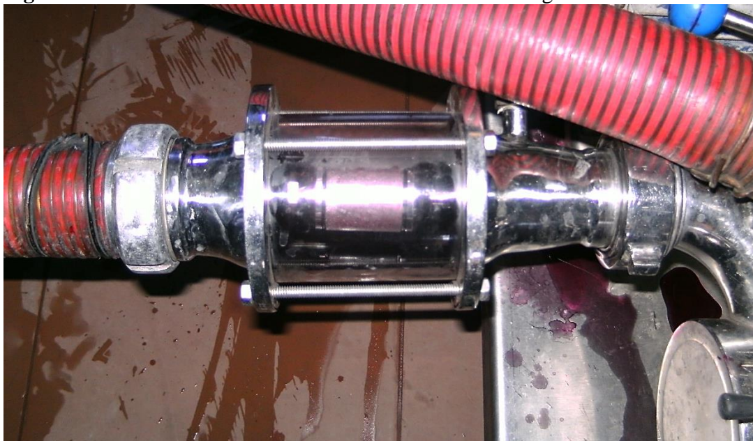
Figura 3-1: Difusor de Gases a la salida de Bomba Centrífuga.
