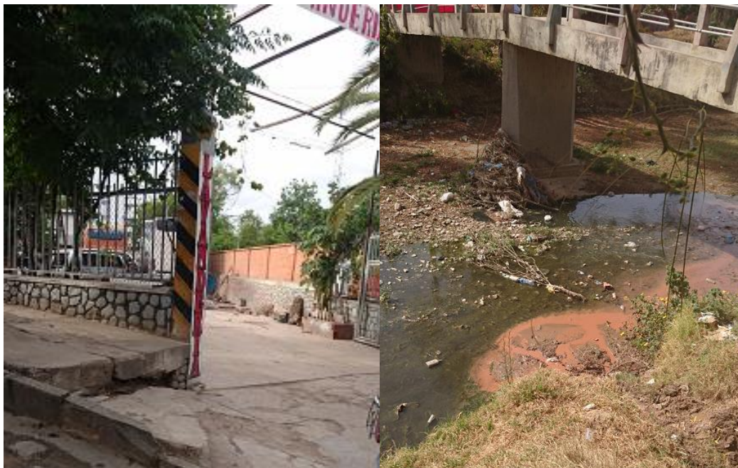
Figura 21 Lavandería de movilidades y descarga la misma a la Quebrada El Monte
