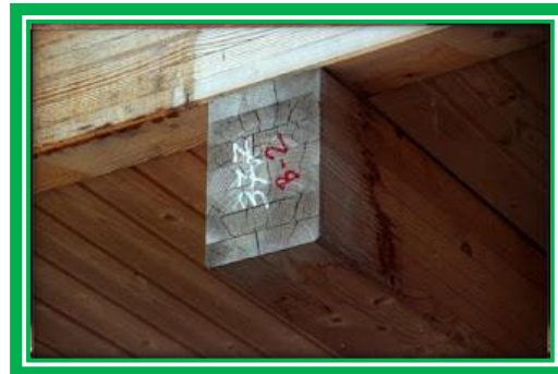
FIGURA N°13: Fendas en un tablón de madera
