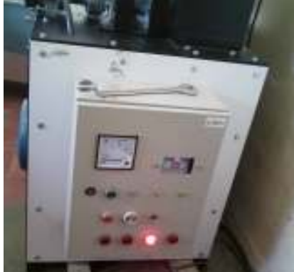
Fotografía 7 Panel del extrusor
