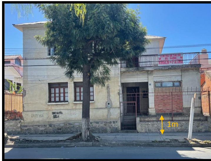
Figura 3.4. – Desnivel de la construcción a la acera
