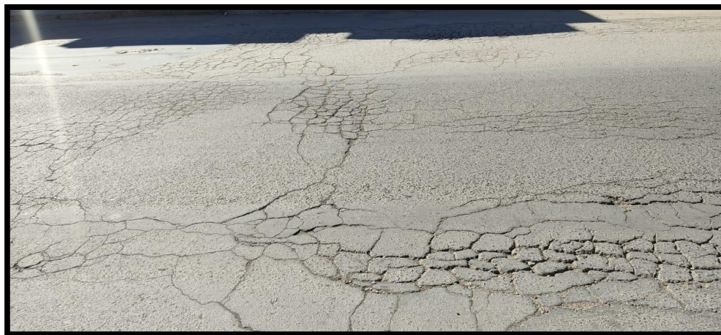
Figura 1.4 Zona de investigación, presencia de piel de cocodrilo en la capa de rodadura Los Molles
