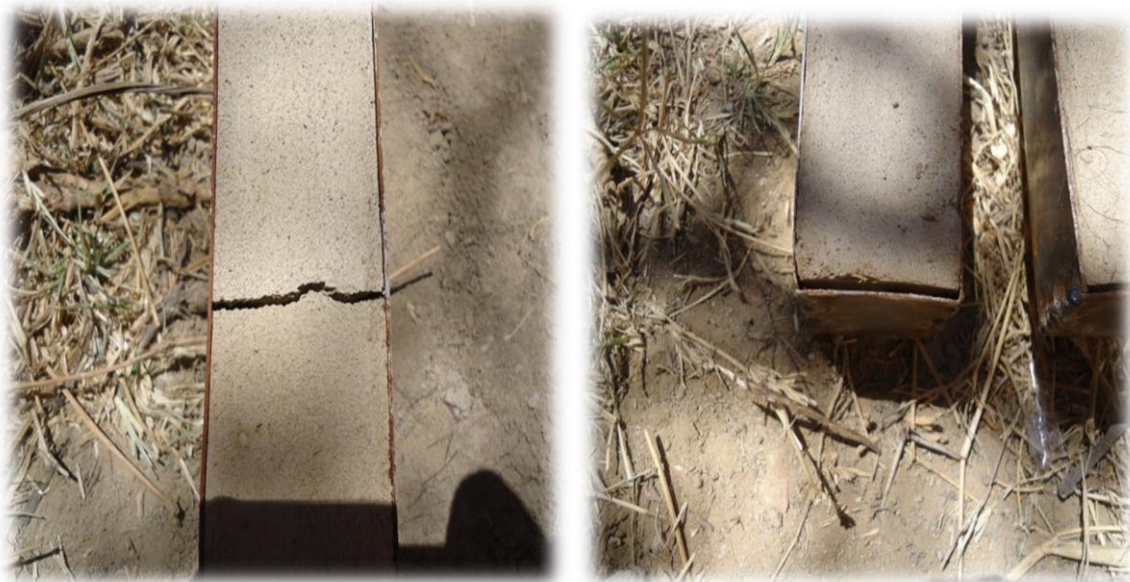
Retracción y fisuras del suelo-cemento para la muestra patrón. [Imagen 22]
