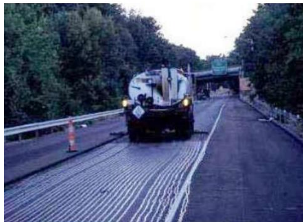
Figura 2.22. Tasa insuficiente de aplicación del riego de liga
