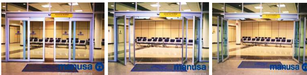
Imagen 103: Puertas Automáticas con Mecanismo Antipánico
