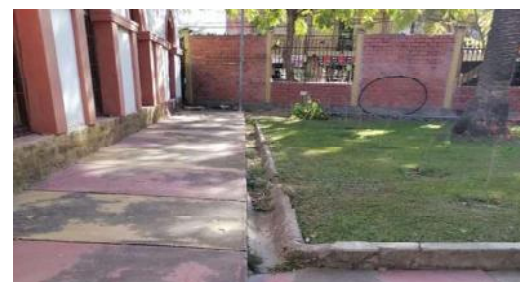
Ilustración 104 - Canal de agua en jardinera.
