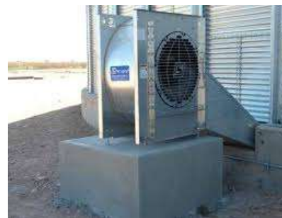
Ilustración 42 Fuente: http://www.emapa.gob.bo/ventilacion de silos
