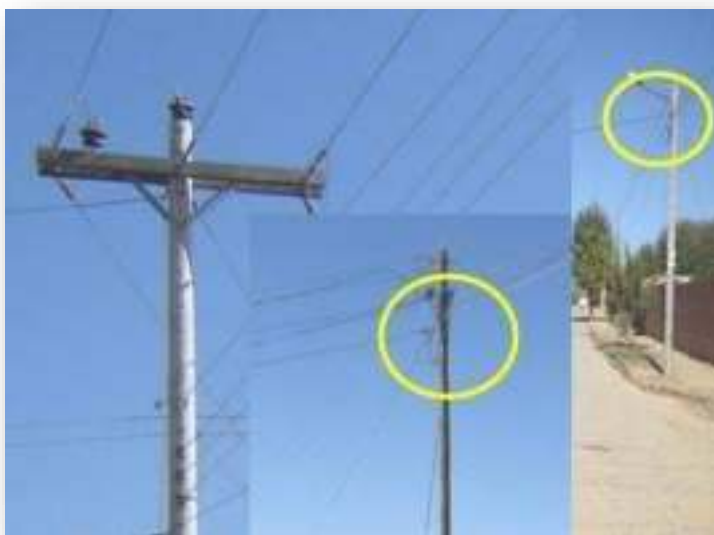
Figura 75. Alumbrado público en distrito 9
