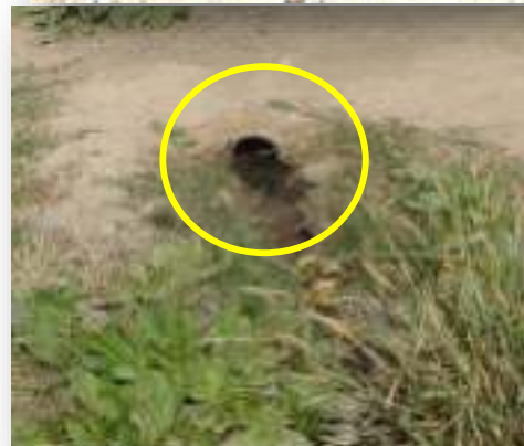
Figura 74. Desagüe de alcantarillado a la calle en Distrito
