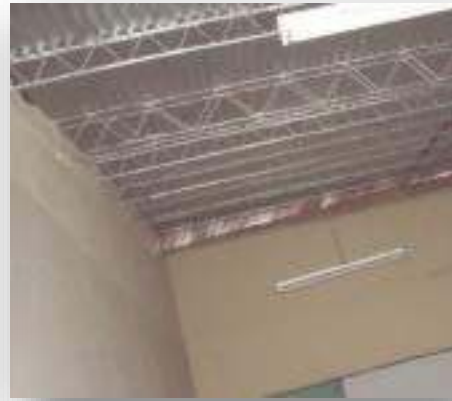
Figura 64. Estructura de metal I.T.C. Infocal
