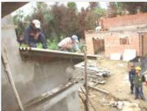
Figura 22. Obreros en cubierta, sin ninguna medida de seguridad
