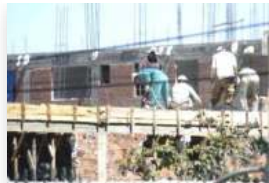
Figura 21. Obreros en losa con indumentaria inapropiada
