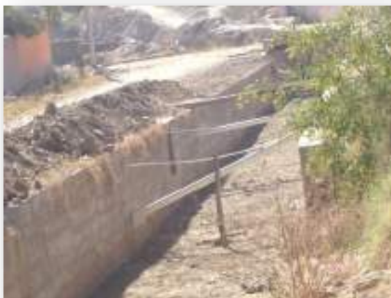
Figura 73. Tuberías de agua potable atravesando canal en distrito 9
