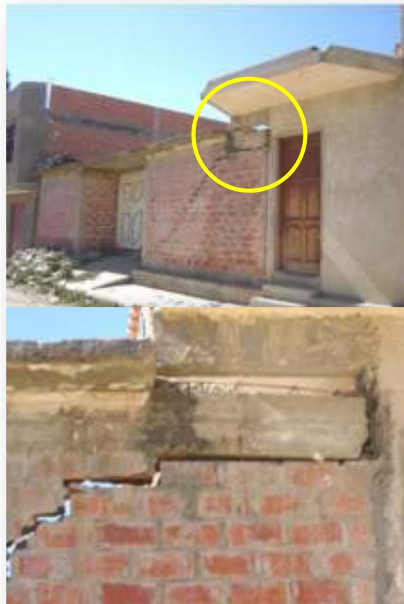
Figura 24. Vivienda en barrio 2 de mayo, muro y viga colapsados
