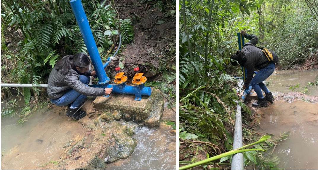
Figura N° 1. Medición de diámetros y longitudes de la bomba comercial. Fuente: Propia.
