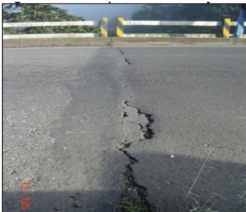
Figura 14: Fisuras de reflexión de junta
