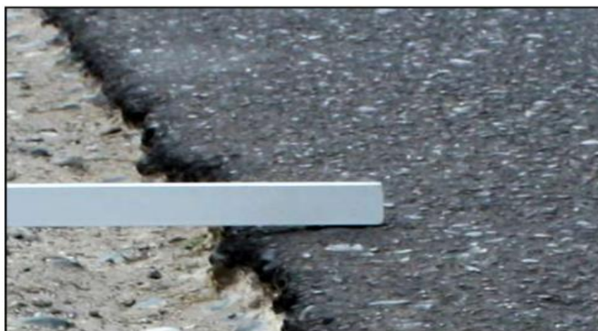
Figura 15: Fisuras de reflexión de junta
