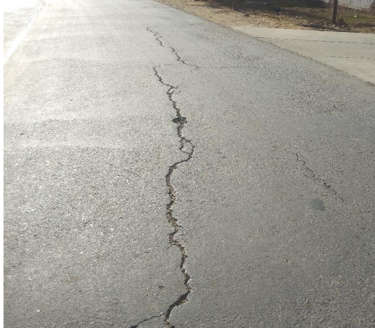
Figura 16: Fisuras longitudinales y transversales
