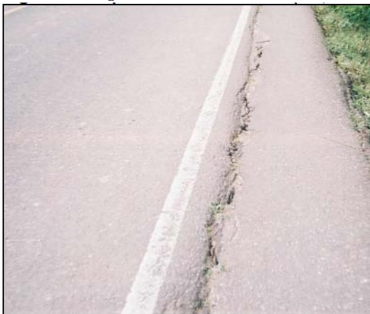
Figura 13: Grieta de borde
