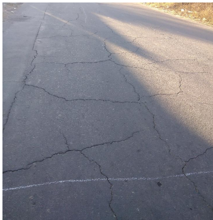
Figura 10: Agrietamiento en bloques
