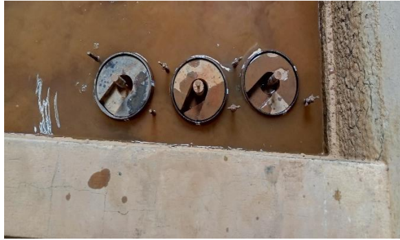
Figura 40: Moldes dentro del depósito de agua
