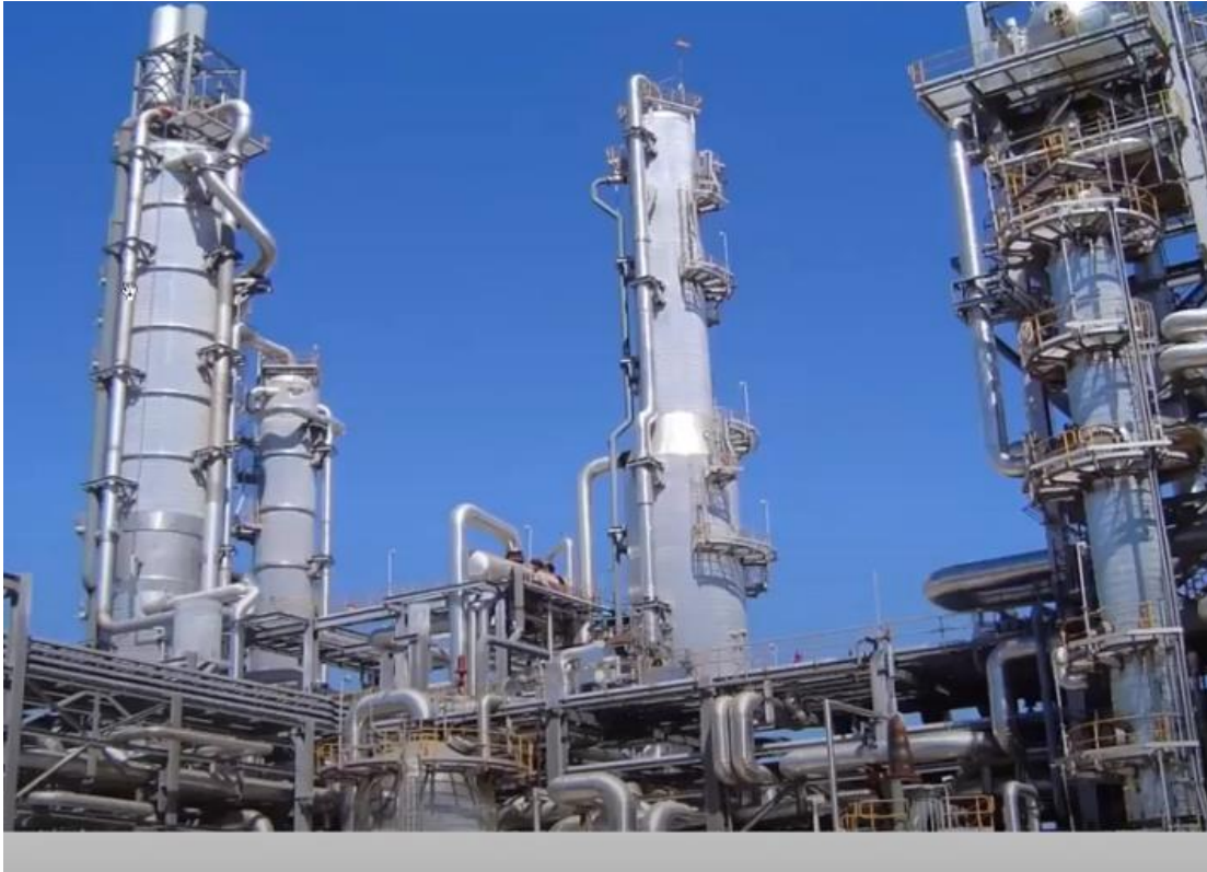
Fig. 1-23. Torre de absorción Bulo-Bulo
