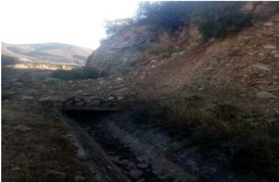
Figura 104. Canal Trapezoidal de Trasvase con derrumbe del talud en la progresiva 8+160 a 8+280.
