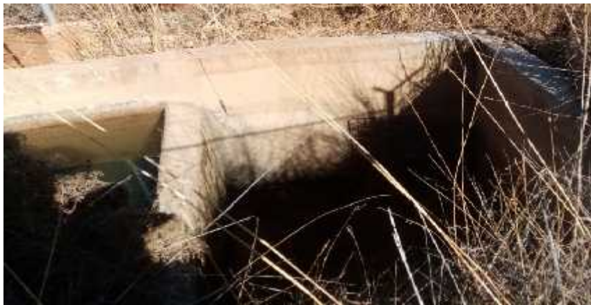
Figura 80. Entrada Sifón N°5 obstruida por malezas en la progresiva 5+077,10.
