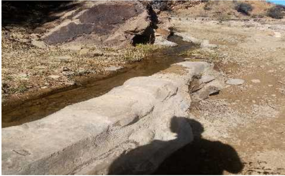
Figura 35. Erosión del canal de riego Tárraga progresiva 0+050 a 0+061.
