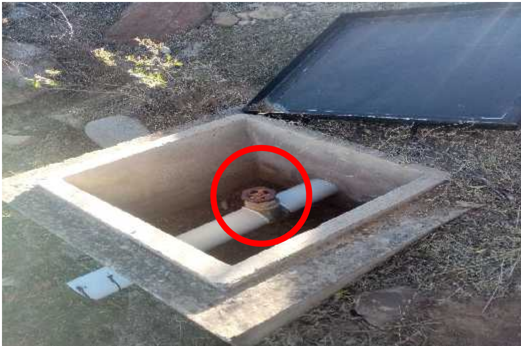
Figura 78. Cámara de limpieza del desarenador de la entrada del sifón N°3.
