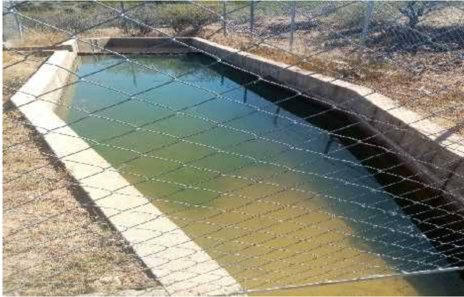
Figura 98. Rejilla de entrada obstruida y desarenador colmatado en la entrada Sifón N°7.
