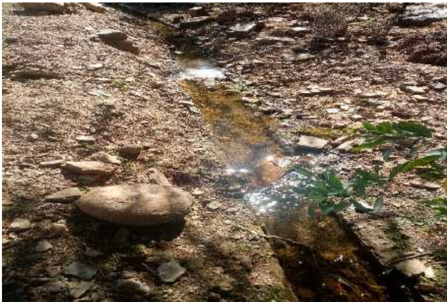
Figura 38. Sedimentación por derrumbe en el canal de riego Tárraga de la progresiva 0+100 a 0+150 (Muestra N° 2).
