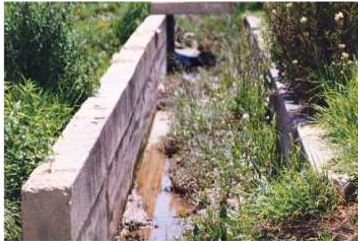
Figura 7. Crecimiento de hierbas en el canal.
