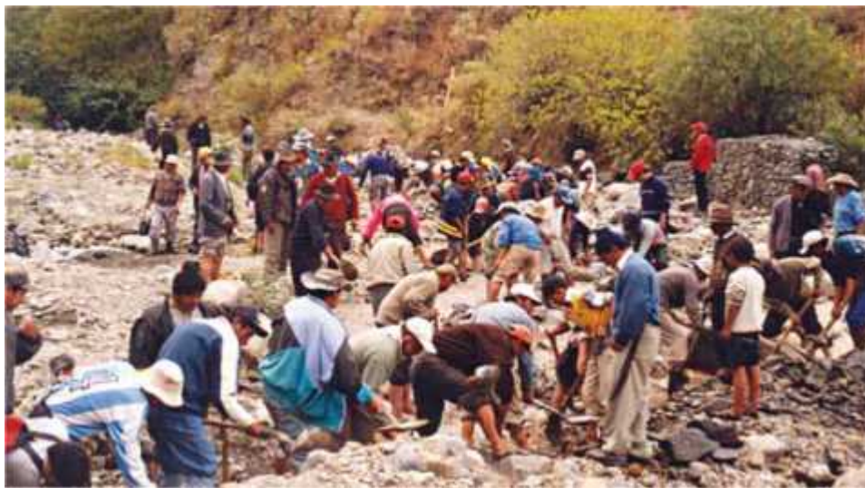
Figura 10. Limpieza tradicional de obra de toma.
