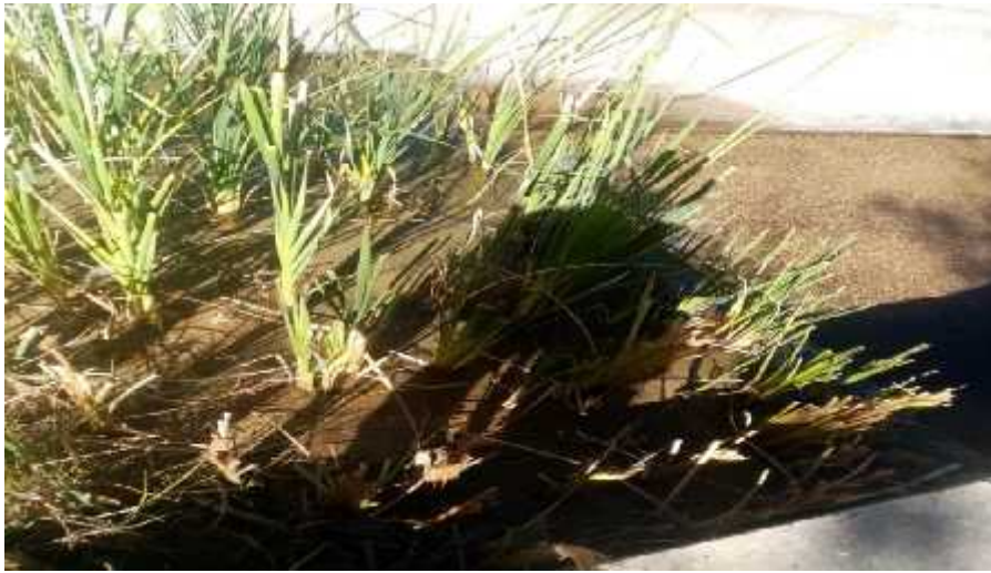
Figura 55. Desarenador de la progresiva 0+076 colmatado hasta la cresta del vertedero del canal de trasvase.
