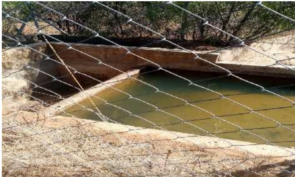
Figura 93. Desarenador N°7 colmatado en la entrada Sifón N°6.
