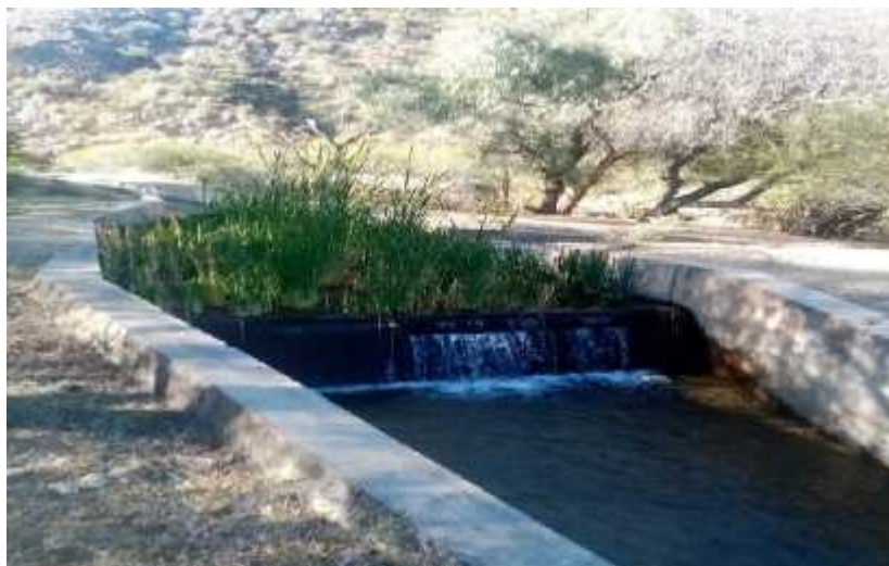
Figura 54. Desarenador Colmatado del sistema de trasvase en la progresiva 0+076.
