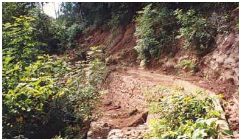
Figura 11. Canal con riesgo de derrumbe.
