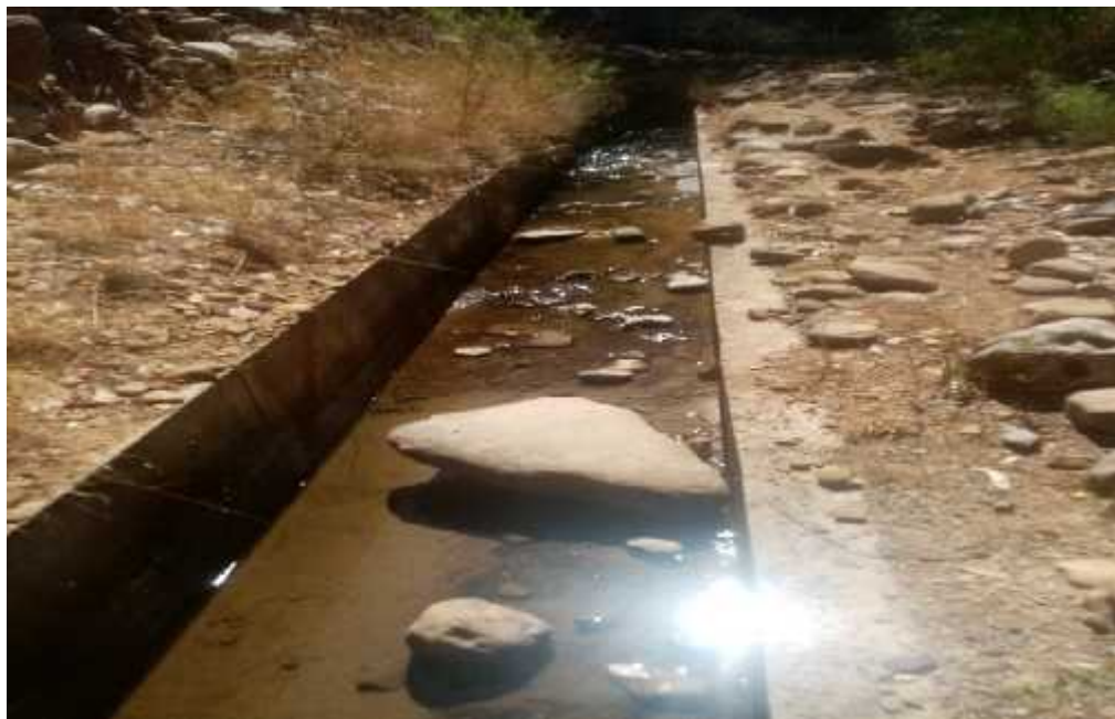
Figura 60. Derrumbe en el canal de trasvase en la progresiva 0+320 a +400.
