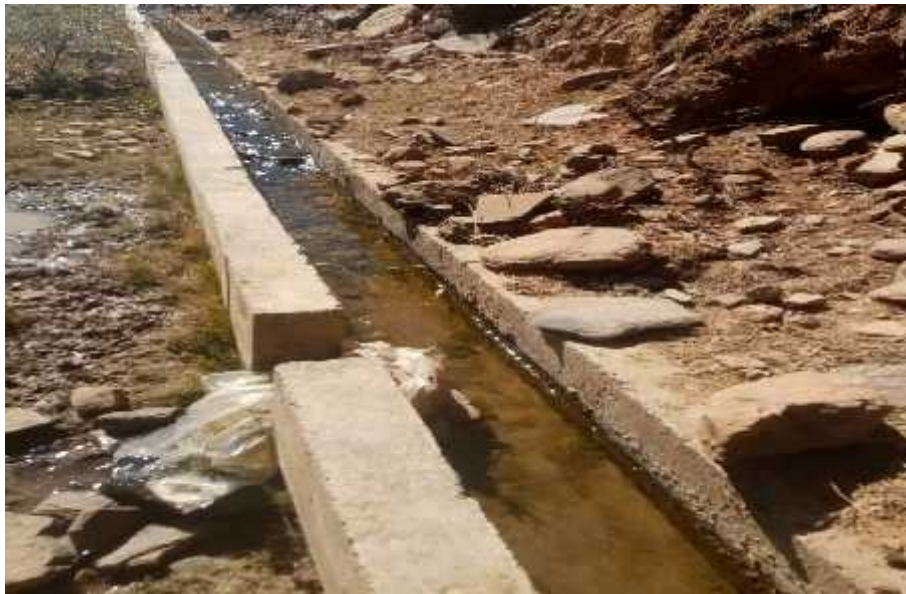
Figura 46. Falta de compuerta de limpieza en la progresiva 0+410.
