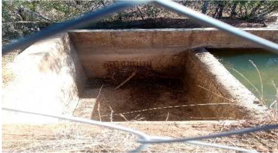
Figura 92. Rejilla de entrada al Sifón N°6 obstruida.
