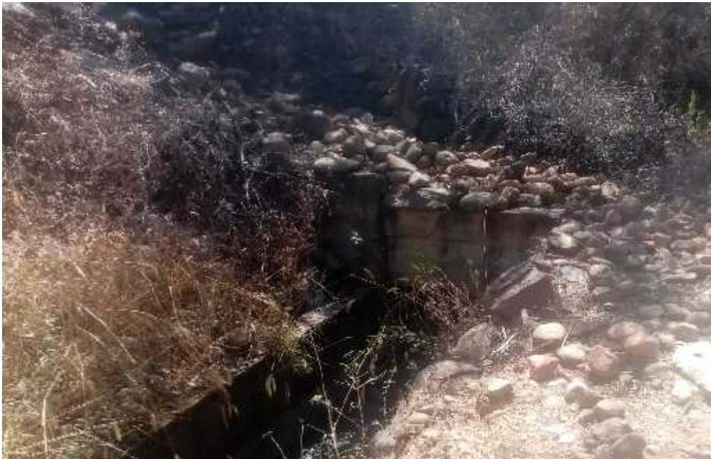
Figura 62. Derrumbe del talud en alcantarilla del canal de trasvase en progresiva 0+220.
