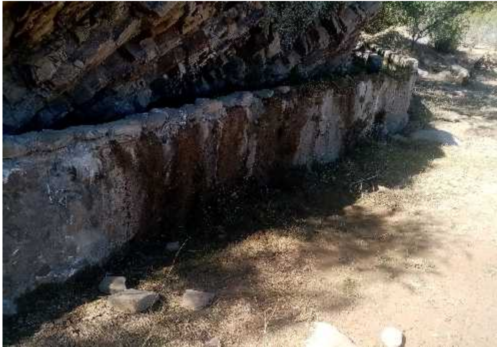
Figura 36. Erosión del canal de riego Tárraga progresiva 0+050 a 0+061.
