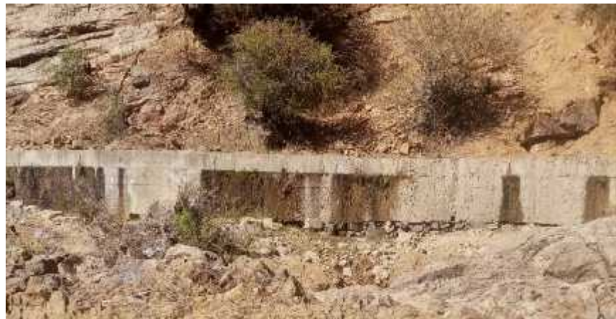
Figura 44. Riesgo de colapso y filtración de agua en el canal de riego Tárraga en la progresiva 0+250 a 0+290.
