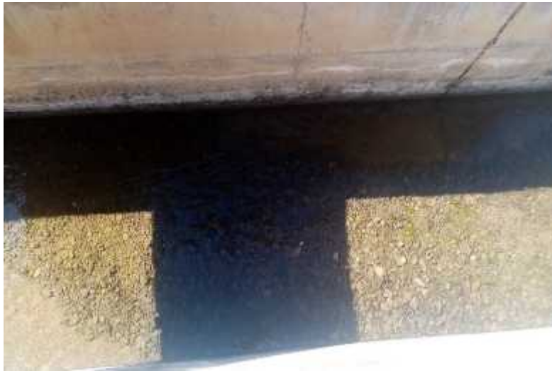
Figura 53. Canal de trasvase sedimentado progresiva 0+000 a 0+076 (Muestra N°1).
