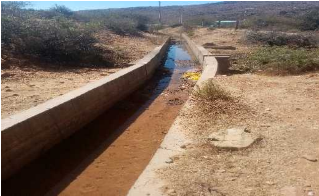
Figura 66. Sedimentación canal de trasvase progresiva 1+000 a 1+542 (Muestra N° 3).
