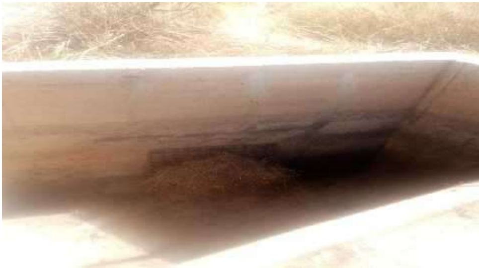
Figura 76. Rejilla de entrada del Sifón N°3 obstruida por malezas y basura en la progresiva 3+779,95.
