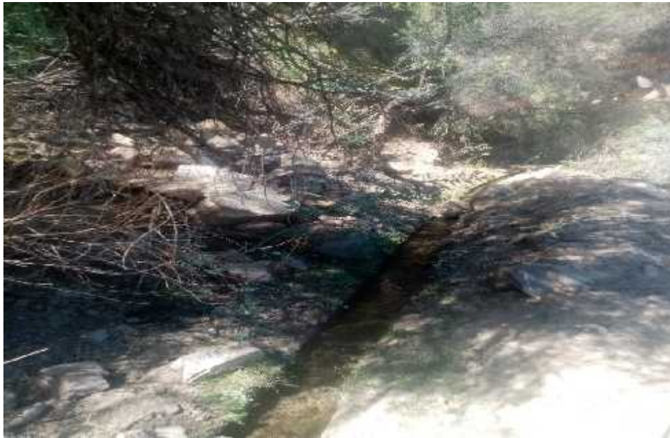
Figura 37. Derrumbe de talud en el canal de riego Tárraga de la progresiva 0+100 a 0+150.
