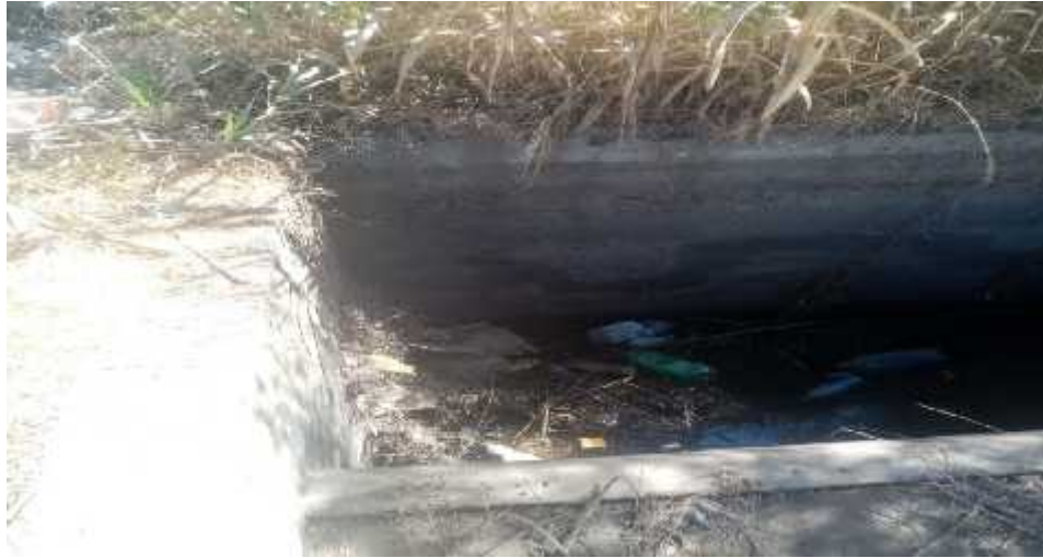
Figura 68. Rejilla en la entrada del Sifón N°1 obstruida por malezas y basura progresiva 1+542.
