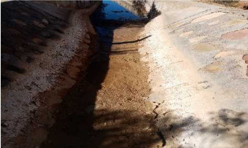
Figura 85. Sedimentos en el canal de trasvase progresiva 5+215,60 a 5+860.
