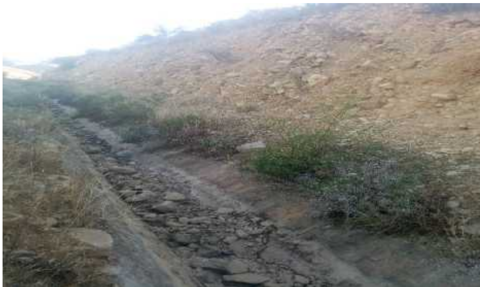
Figura 103. Canal Trapezoidal de Trasvase con sedimento de gran tamaño progresiva 8+160 a 8+280.
