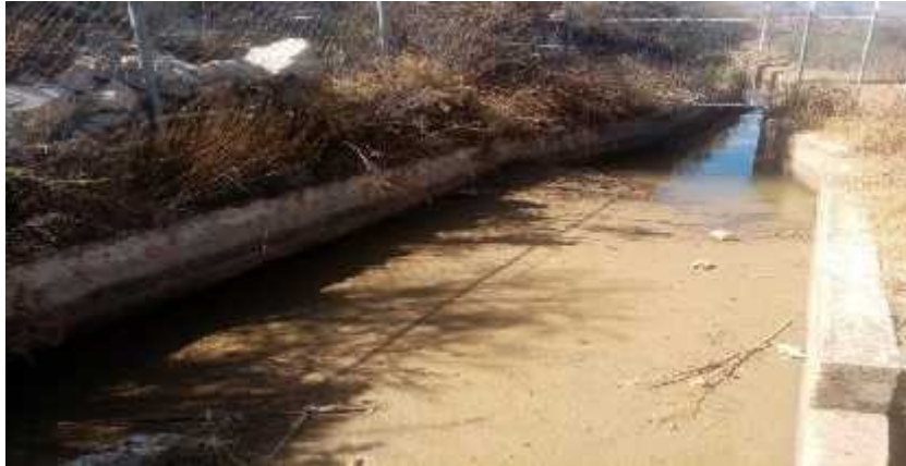
Figura 79. Desarenador colmatado de la entrada Sifón N°4.
