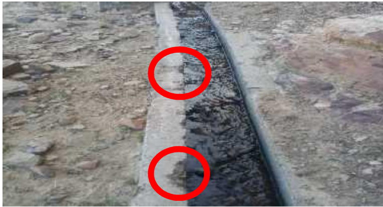
Figura 33. Daños en el canal de riego Tárraga en la progresiva 0+000 a 0+010.
