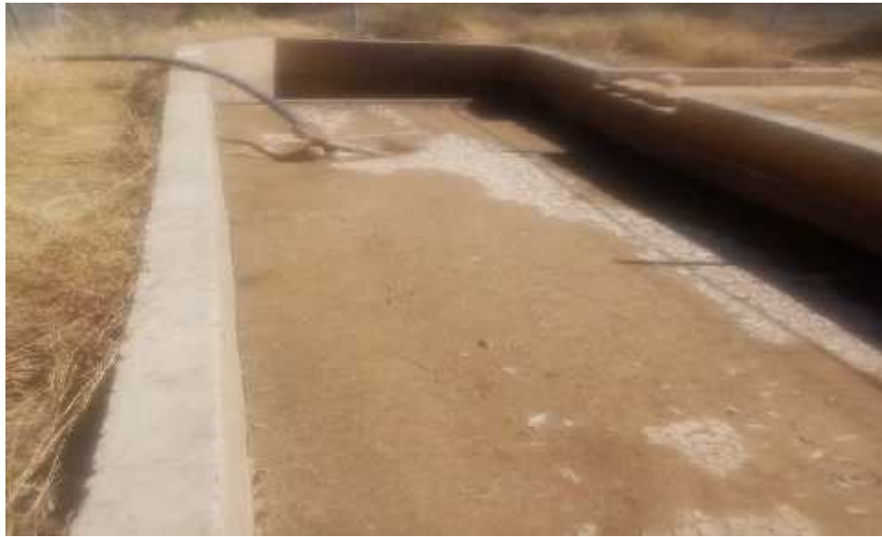
Figura 77. Desarenador colmatado de la entrada Sifón N°3.
