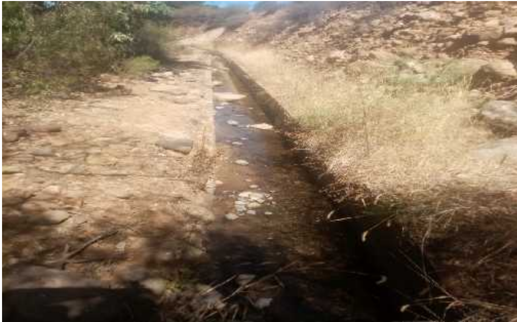
Figura 59. Sedimentación canal de trasvase progresiva 0+090,50 a 1+000 (Muestra N° 2).
