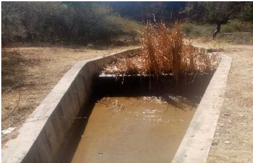
Figura 25. Desarenador del sistema de trasvase en la progresiva 0+076.
