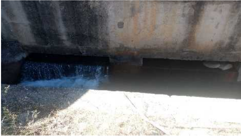
Figura 49. Bocatoma del sistema de trasvase (vista interior).
