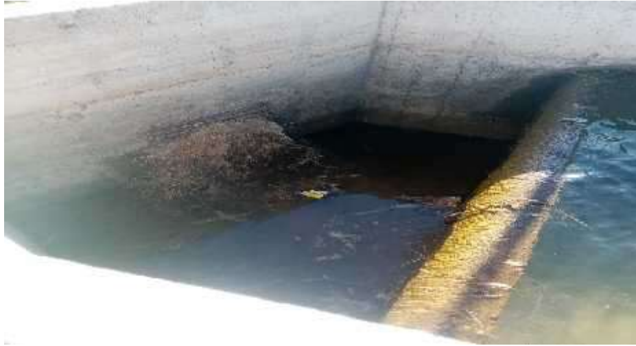
Figura 70. Rejilla de entrada del Sifón N°2 obstruida por malezas y basura en la progresiva 3+061,40.
