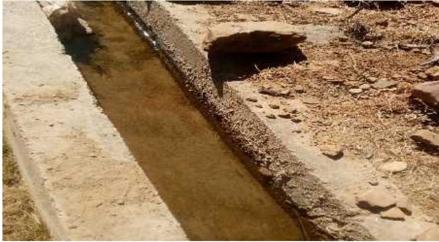
Figura 43. Sedimento en canal Tárraga progresiva 0+250 a 0+400. (Muestra N° 4)
