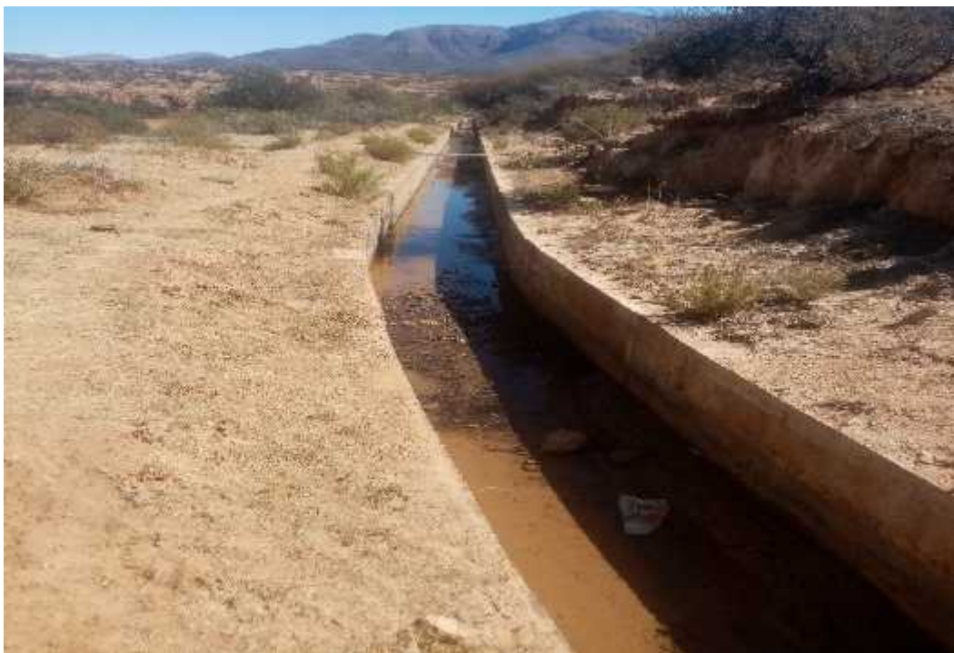
Figura 67. Sedimentación en el canal de trasvase progresiva 1+500.
