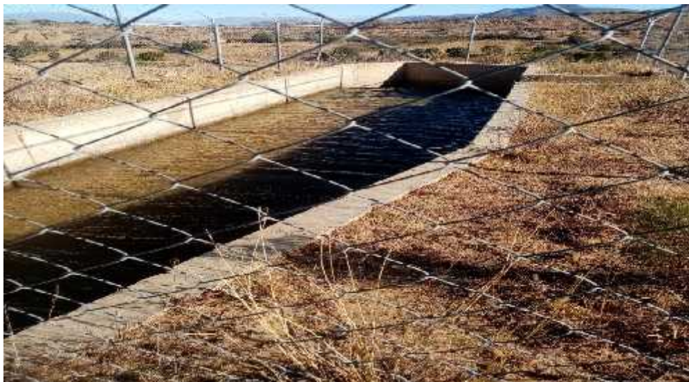
Figura 71. Desarenador colmatado de la entrada Sifón N°2 de la progresiva 3+061,40.
