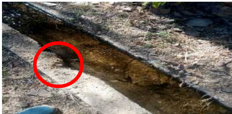
Figura 40. Daños en el canal de riego Tárraga en la progresiva 0+200.
