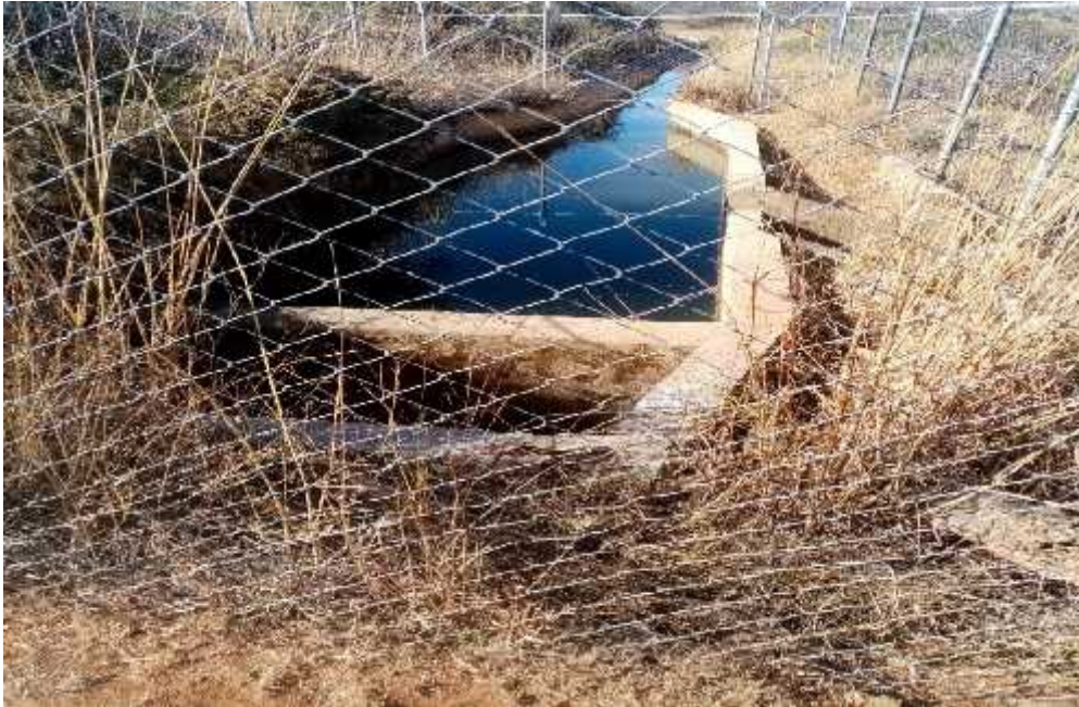
Figura 81. Desarenador colmatado de la entrada al sifón N°5.
