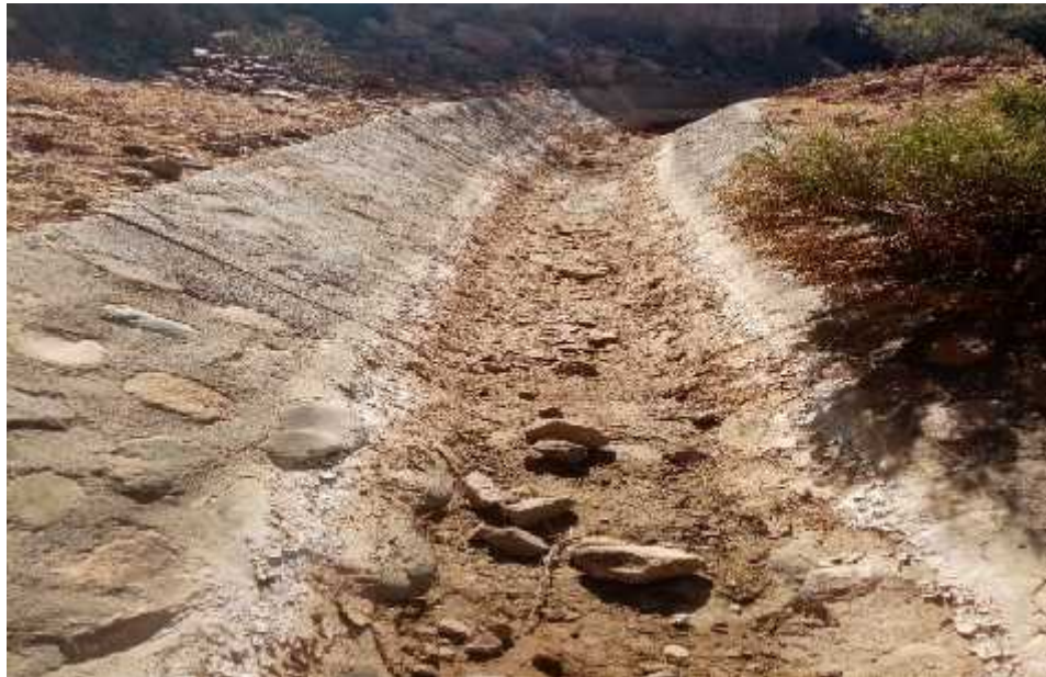
Figura 84. Sedimentos canal de trasvase progresiva 5+215,60 a 5+860 (Muestra N°5).
