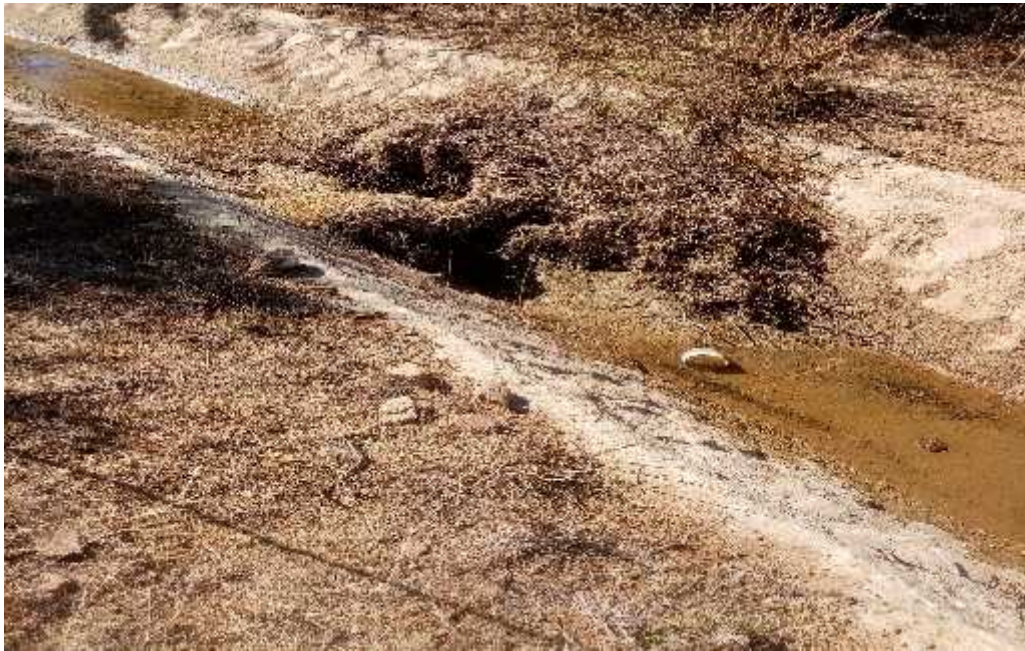
Figura 90. Canal de trasvase con obstrucciones de malezas progresiva 5+860 a 6+738.
