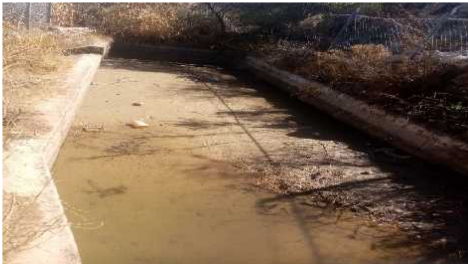
Figura 69. Desarenador N°2 colmatado de la progresiva 1+542.
