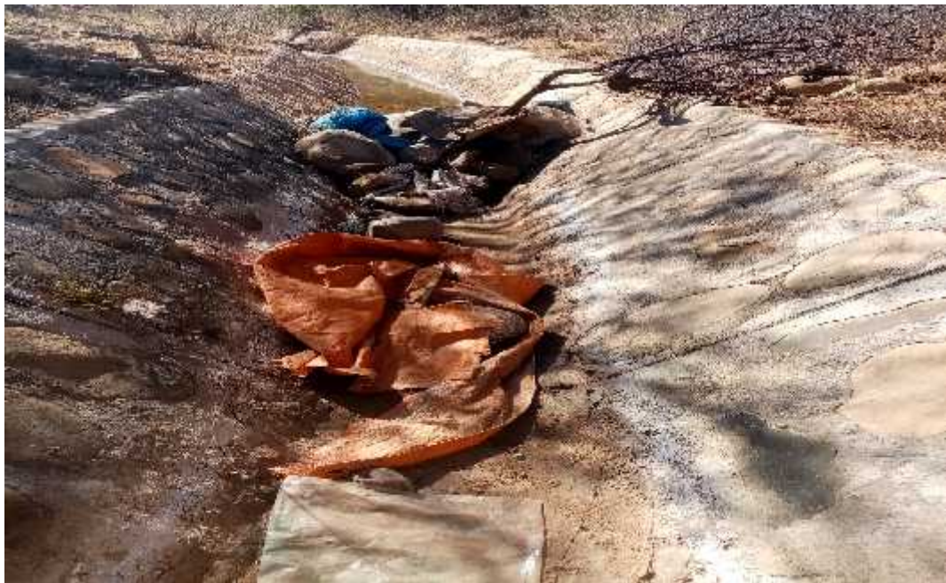
Figura 91. Canal de trasvase con obstrucciones de basuras progresiva 5+860 a 6+738.
