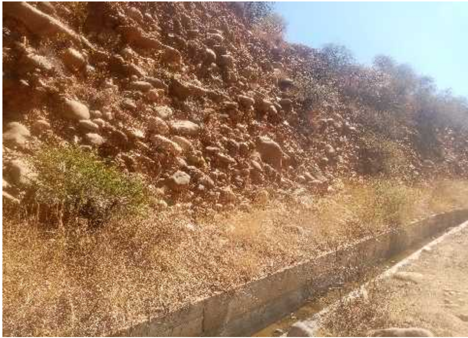
Figura 61. Inestabilidad de talud en progresiva 0+320 a +400.
