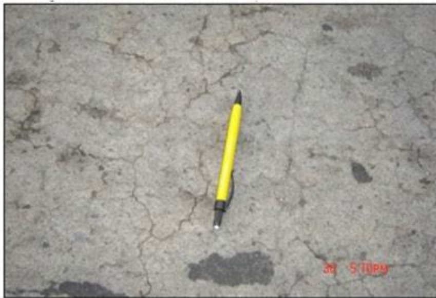
Fisuras de Retracción Plástica
