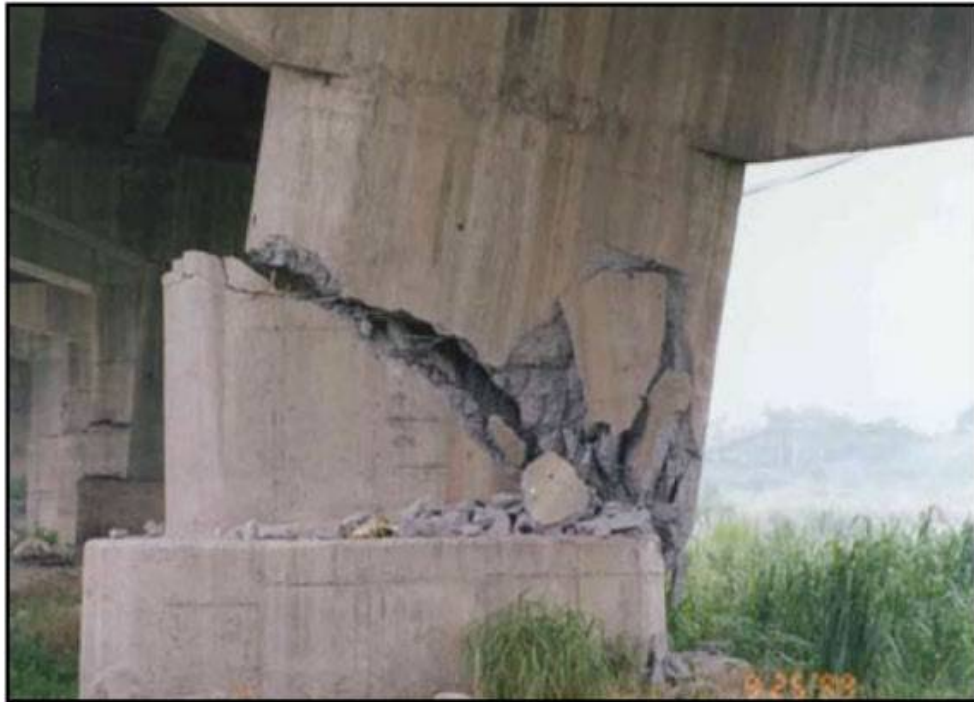
Fractura por Cortante en la Pila
