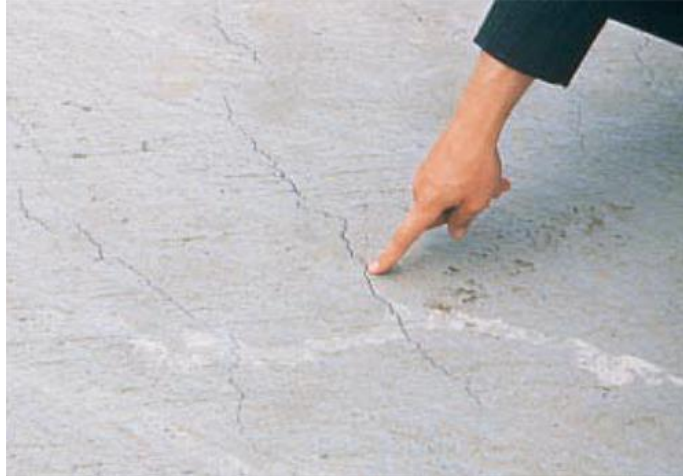
Figura 2.10. Fisuración por retracción plástica
