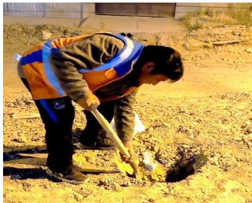
Figura 3.7 Extracción de la muestra
