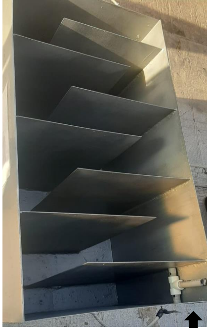
Dispositivo de entrada de agua al biofiltro
