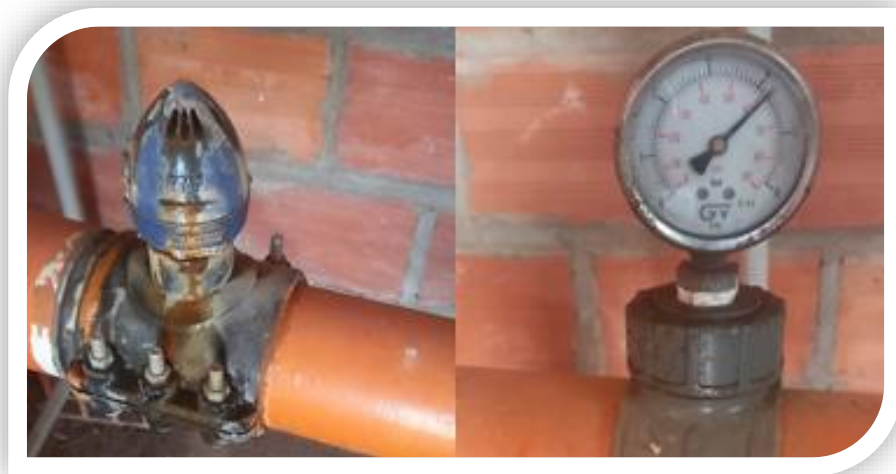
Fotografía 7. Purgador de aire y manómetro de glicerina de 6,0 bares de capacidad
