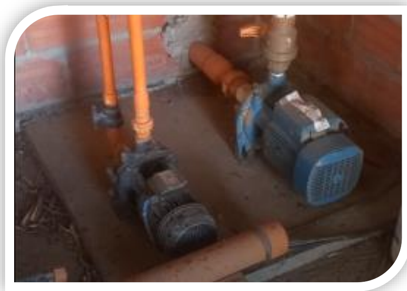
Fotografía 4. Bombas de agua de 3,40 Hp y 5,50 Hp que dotan la energía al sistema
