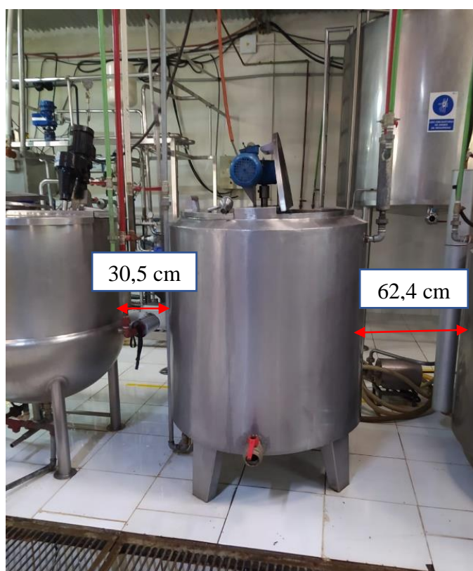
Figura 3-21. Proximidad de los Tanques de Cocimiento
