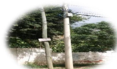
Figura 122 Poste de luz (Fotografía)
