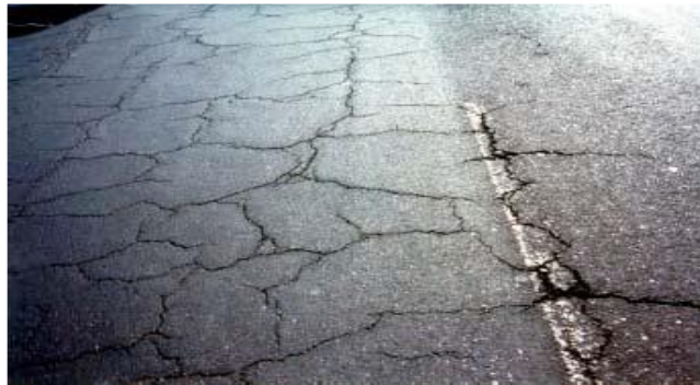
Figura 5. Agrietamiento en bloque
