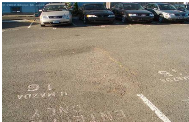
Figura 6. Abultamiento y hundimiento
