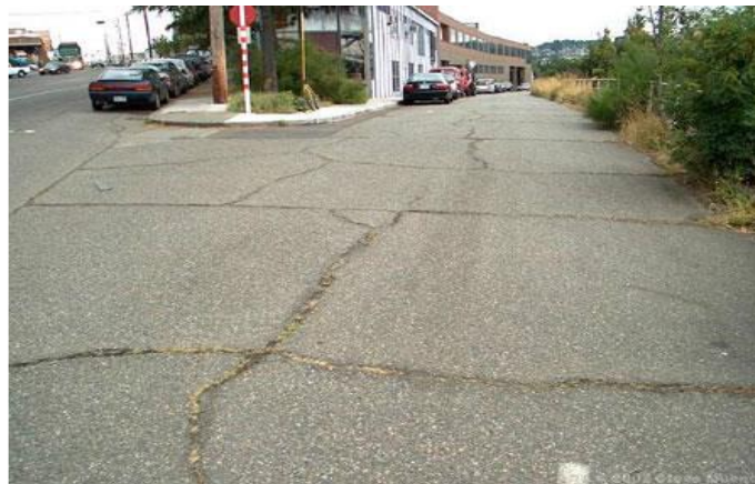
Figura 10. Grieta de deflexión de junta
