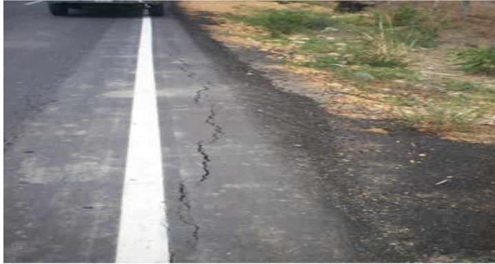
Figura 9. Grieta de borde
