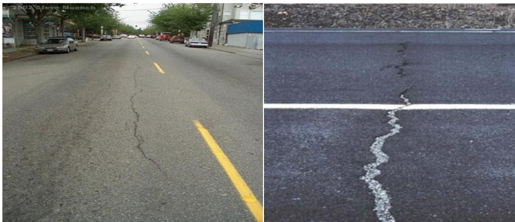
Figura 12. Grieta longitudinal y transversal
