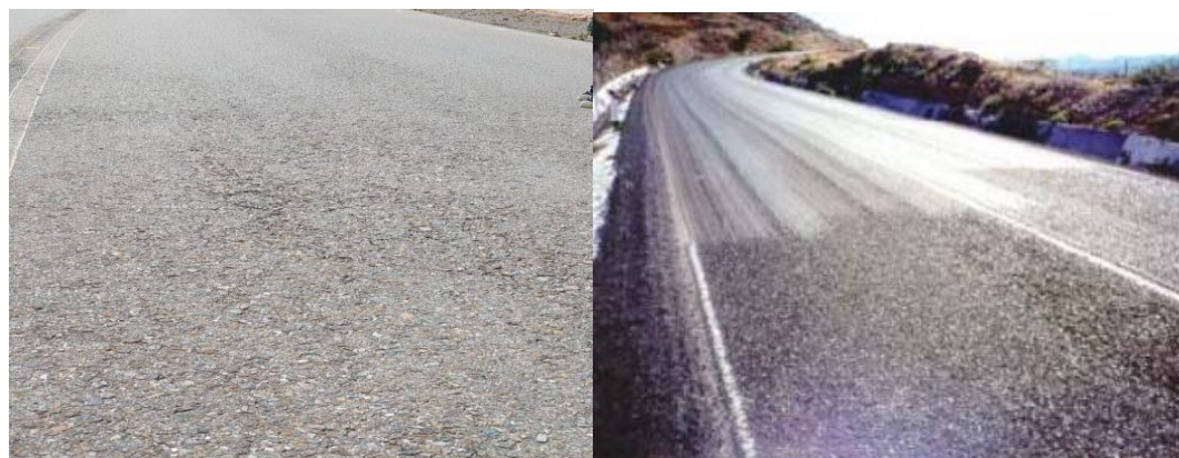
Figura 21. Meteorización/desprendimiento de agregados
