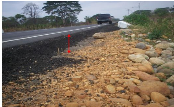
Figura 11. Desnivel de carril/berma
