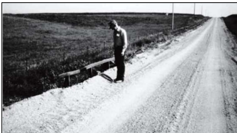
Figura 26. Perdida de grava
