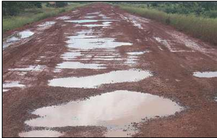
Figura 29. Falla de baches
