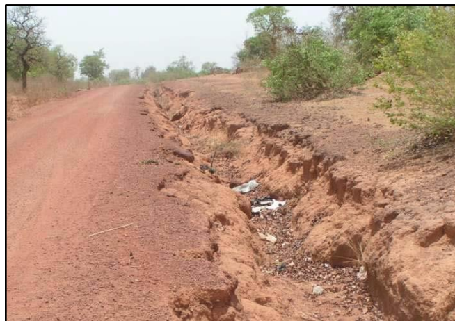
Figura 35. Erosión u obstrucción de cunetas
