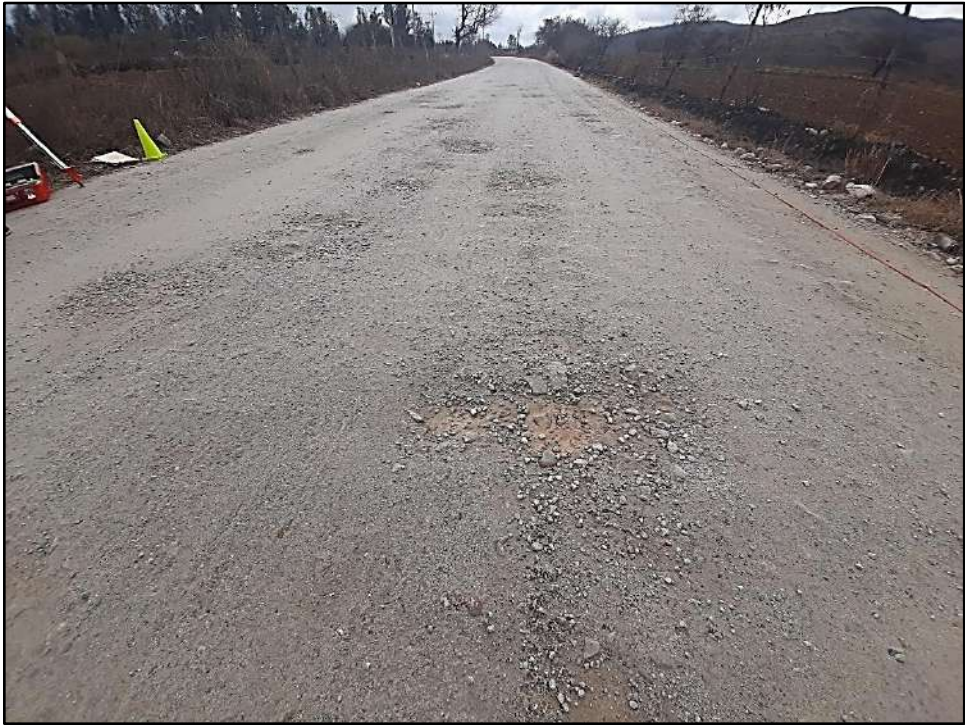
Baches, UM. 1, Tramo Bella Vista – Pinos Sud
