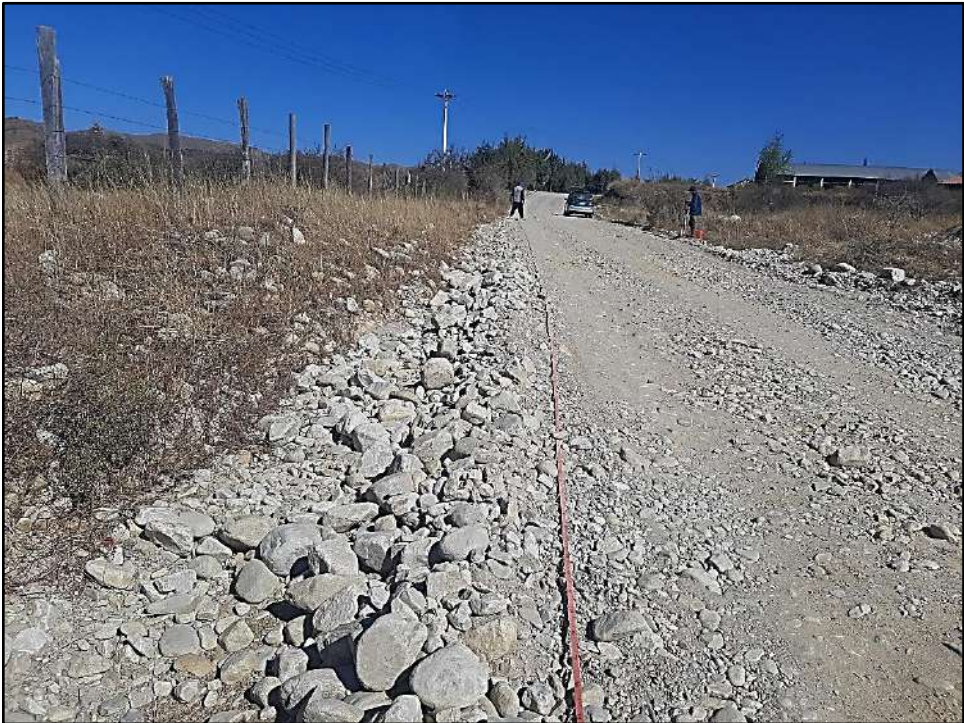
Erosión de cunetas, UM. 10, Tramo Bella Vista – Pinos Sud
