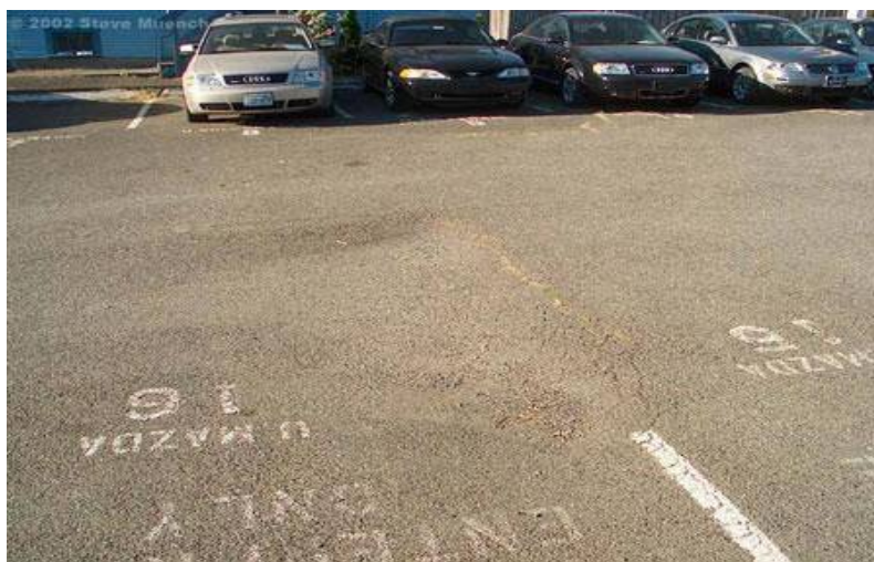
Figura 2.12: Abultamientos y hundimientos
