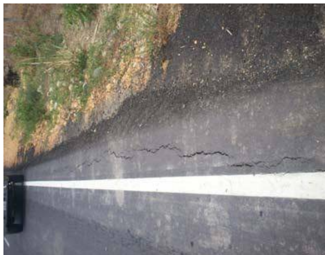
Figura 2.14: Grietas de borde
