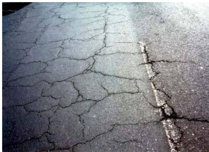
Figura 2.11: Fisuras en bloque
