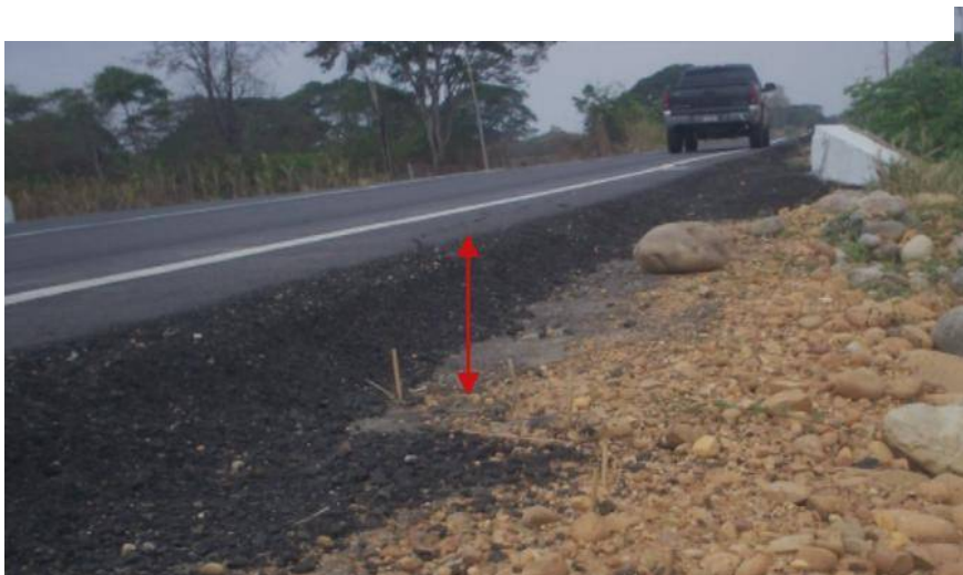
Figura 2.16: Desnivel carril berma
