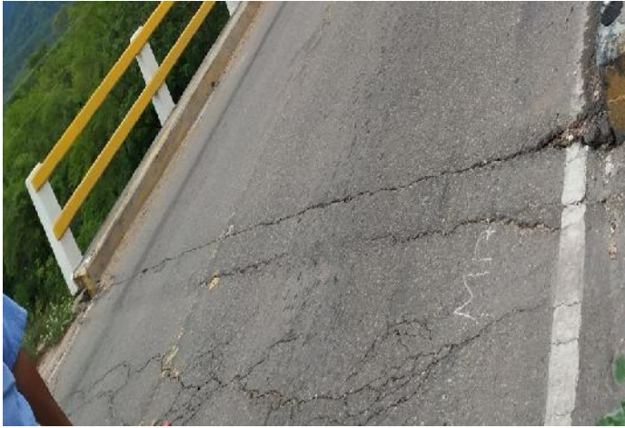
Fotografía 8: Fisuras longitudinales y transversales coord. 21°51'59.98" S 63°37'21.95" O (4+500)
