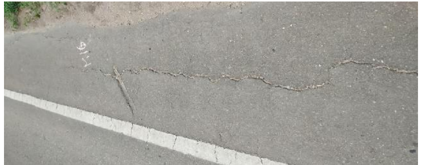
Fotografía 9: Fisuras de borde coord. 21°51'50.22" S 63°37'17.47" O (4+832)
