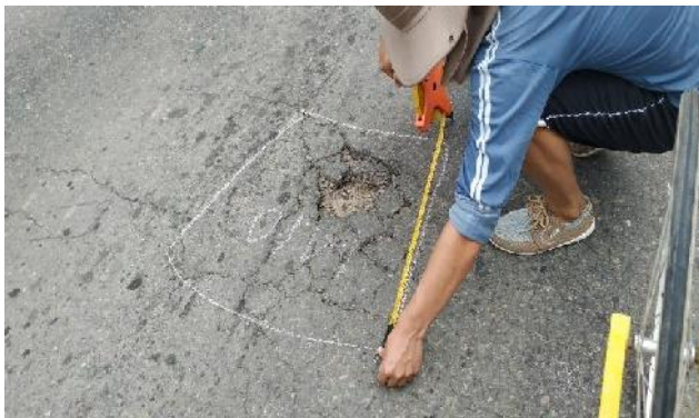
Fotografía 5: Huecos (progr. 2+384) coord. 21°53'08,61"
