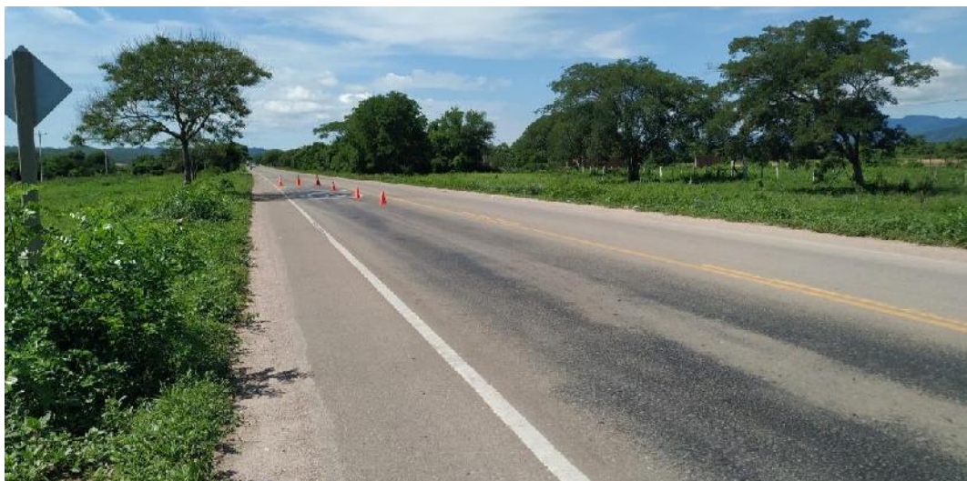
Fotografía 10: Exudación coord. 21°51'46.83" S 63°37'14.76" O (4+960)
