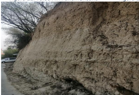
Figura 22. Talud Av. Panamericana
