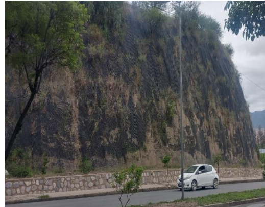
Figura 25. Talud Av. H. de la Independencia
