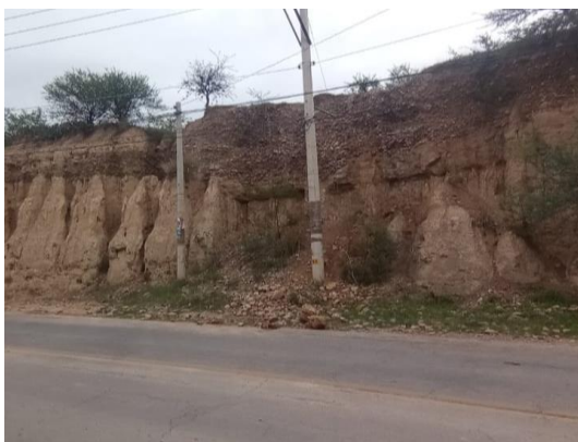
Figura 24. Talud Ruta San Jacinto
