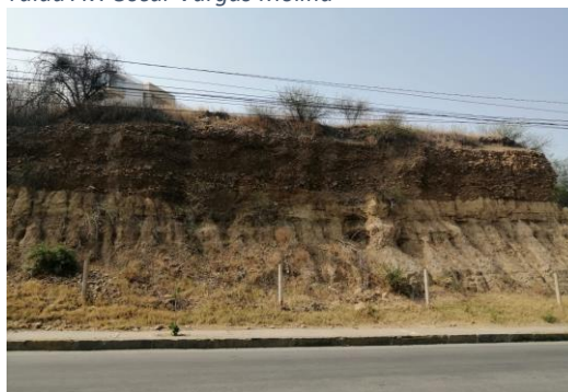
Figura 23. Talud Av. Oscar Vargas Molina
