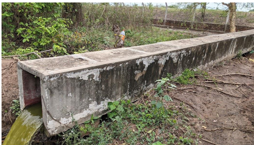
Figura 4.10. Canal de descarga a la salida de la PTAR.
