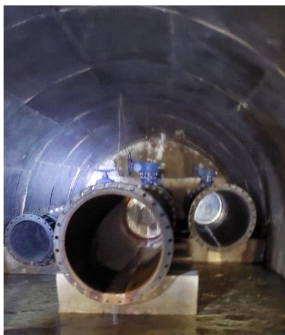
Figura 3.4. Emplazamiento en la Galería sistemas desfogue de fondo y riego.
