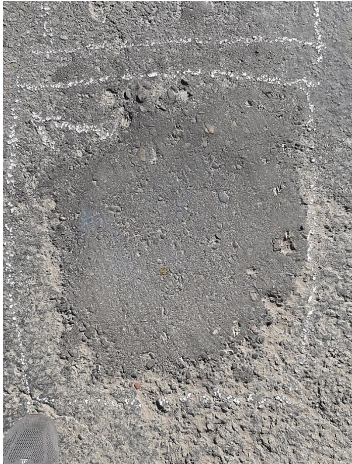
Figura 17 Parcheo y acometidas de servicios públicos de baja severidad.
