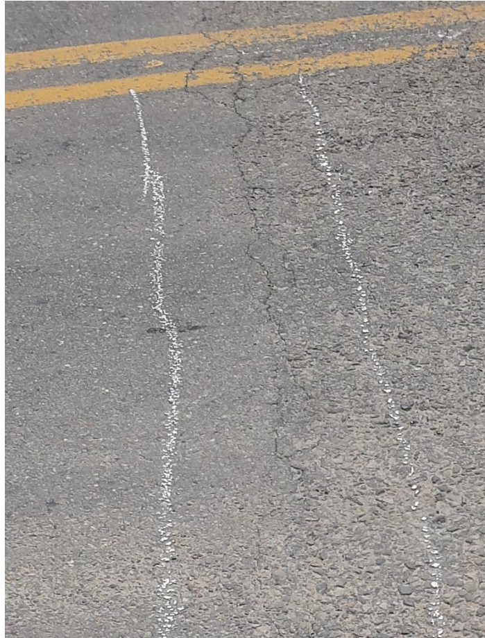
Figura 9 Grietas longitudinales y transversales de baja severidad.
