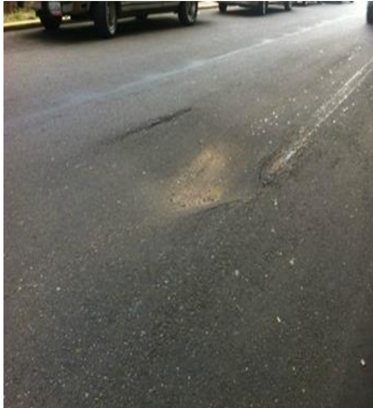
Figura 11 Depresión de baja severidad.
