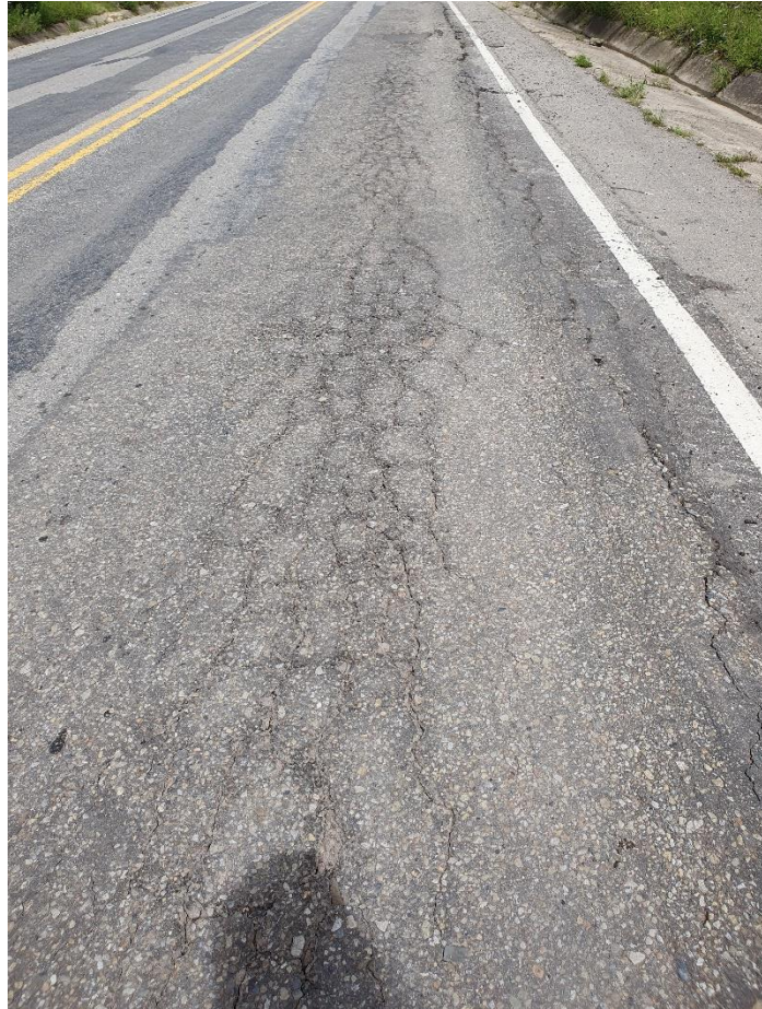
Figura 10 Abultamientos y hundimientos de severidad media.
