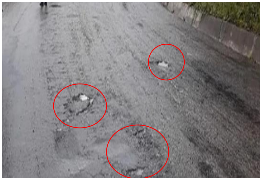
Figura 1 Fallas existentes en el tramo Canaletas – Entre Ríos
