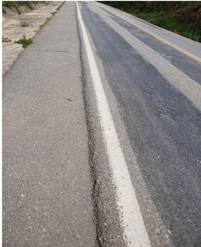
Figura 16 Desnivel carril/berma de baja severidad.
