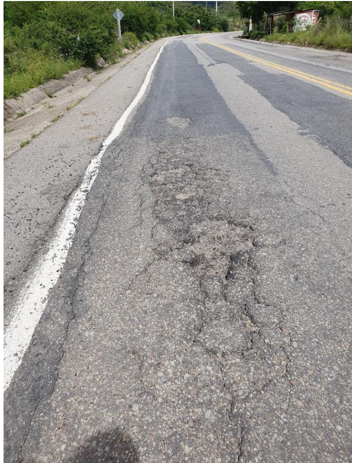
Figura 7 Grietas en bloque de alta severidad.
