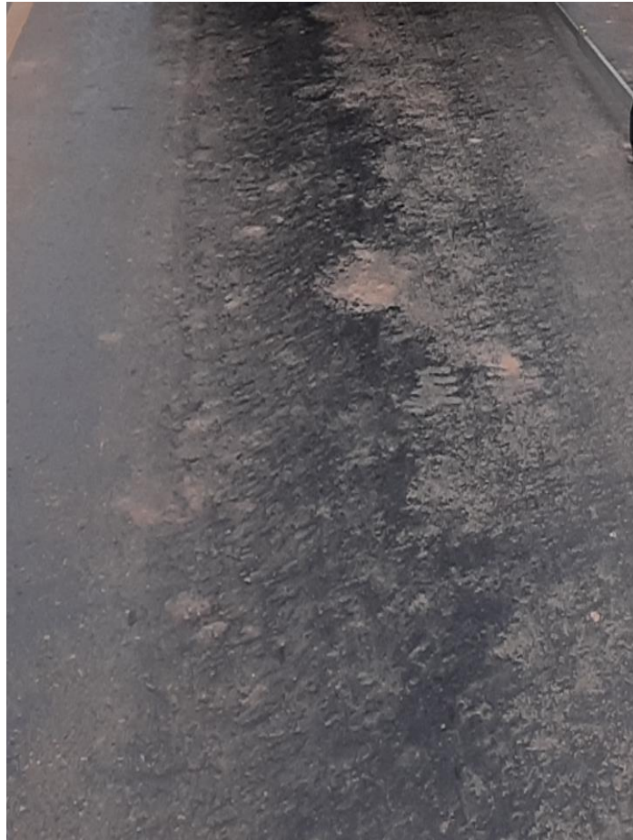
Figura 14 Exudación de baja severidad
