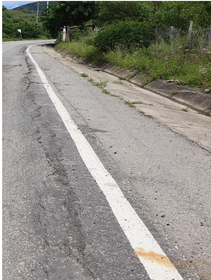
Figura 8 Grieta de borde de severidad media.
