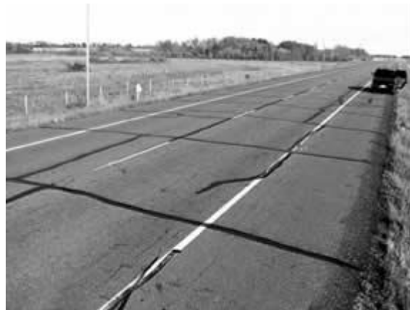
Figura 2.7: Efecto de la poca resistencia a la fatiga de la mezcla asfáltica.
