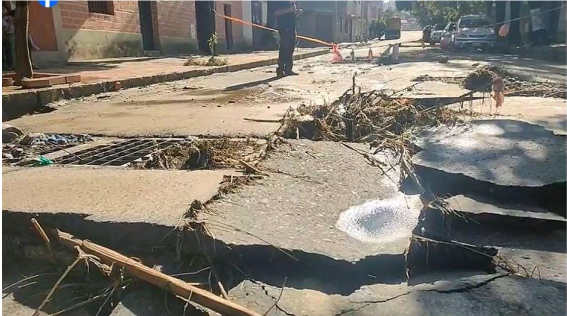
Figura 2.3: Muestra de poca durabilidad de la mezcla asfáltica.
