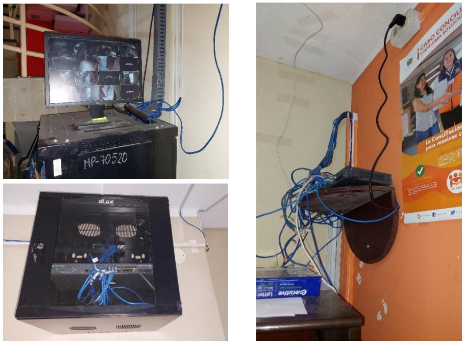
Figura 99. Rack de segunda planta y switch de primera planta
