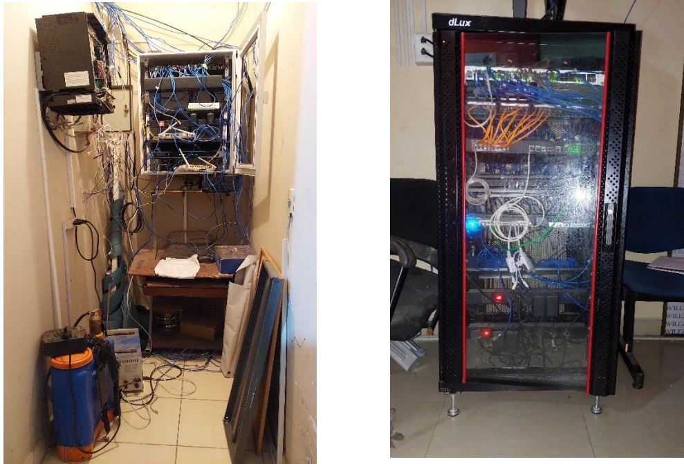
Figura 98. Rack principal de la red y de planta baja de la institución
