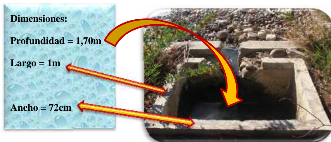
Fotografía 16 Cámara de Desagüe
