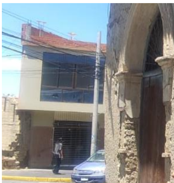
Ilustración 50 Pandeo de Muros exteriores.
