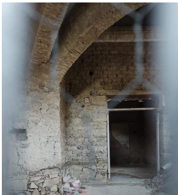
Ilustración 54 Carencia de revestimiento en muros interiores.
