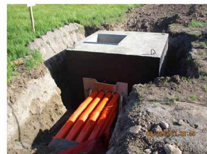
CAMARA DE DISTRIBUCION ELECTRICA EXTERIOR
